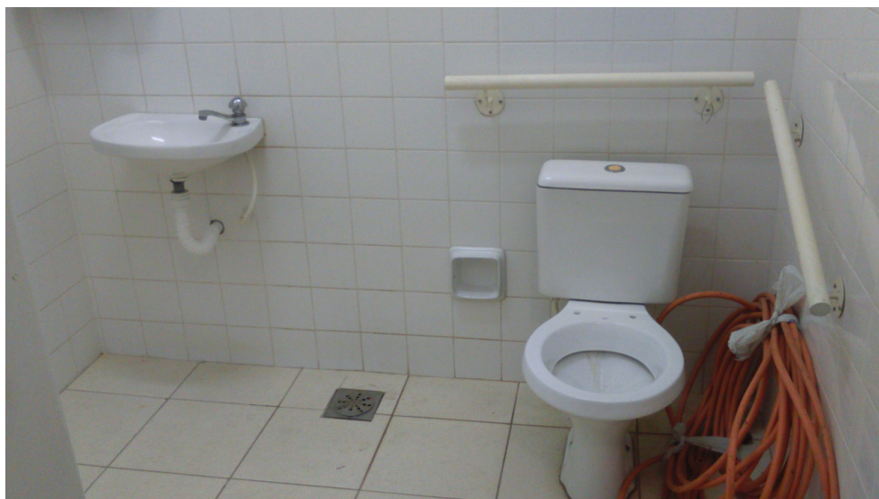
Banheiro de usuários masculino adaptado. Desativado por vazamentos
