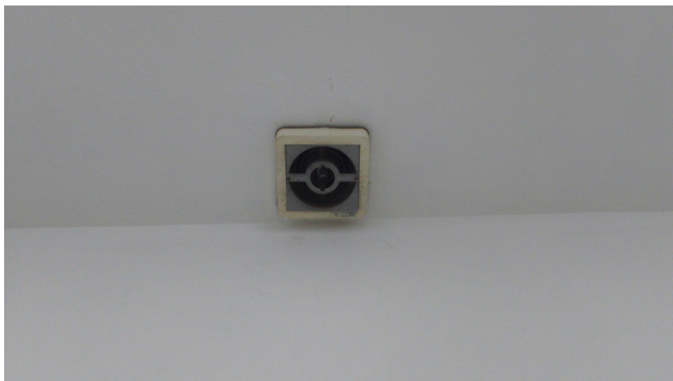
Exaustor danificado do banheiro masculino de usuários.
