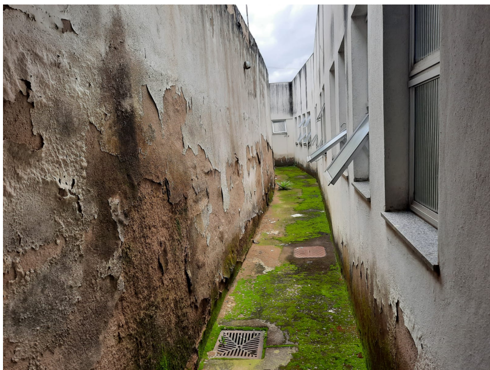
Corredor interno com umidade e presença de lodo
