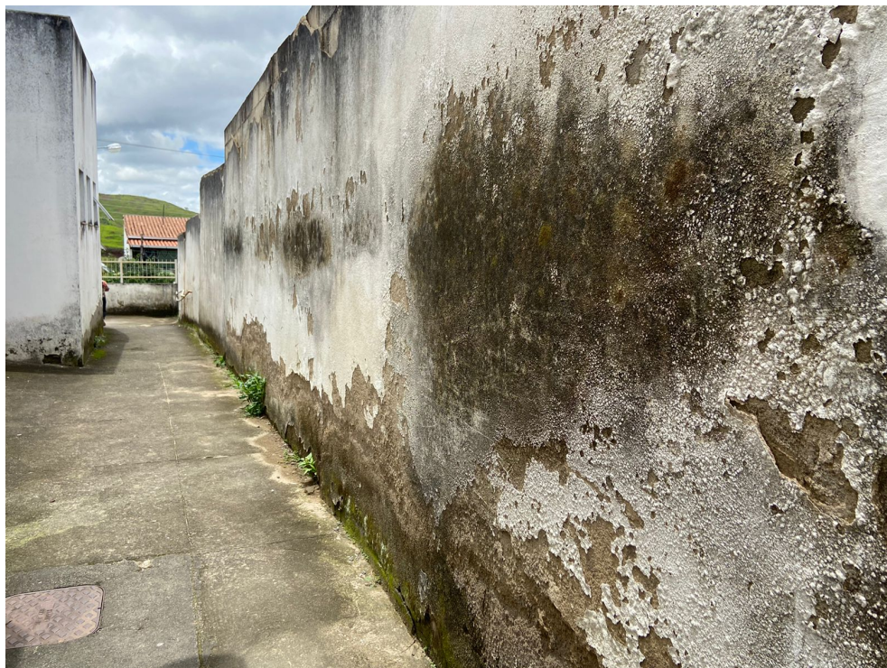
Muro interno da UBS com acabamento danificado
