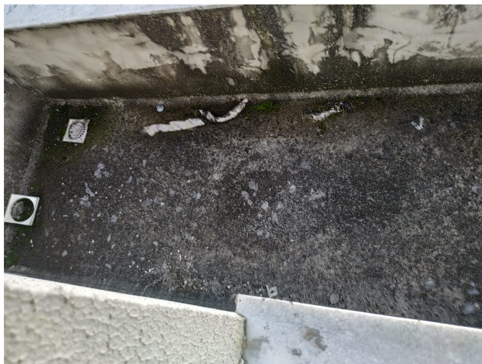
Mofo e infiltração na laje da UBS
