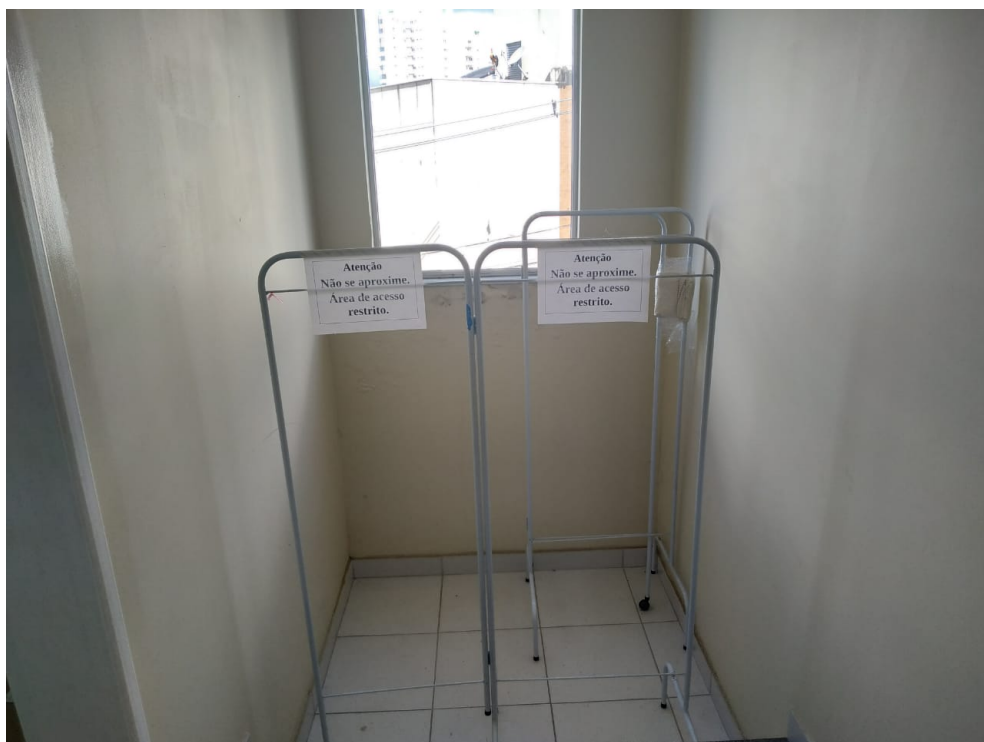
Falta de elevador para portadores de necessidades especiais
