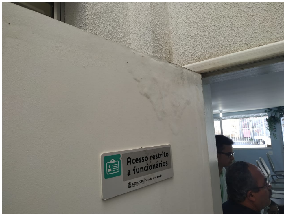
Porta com área de mofo
