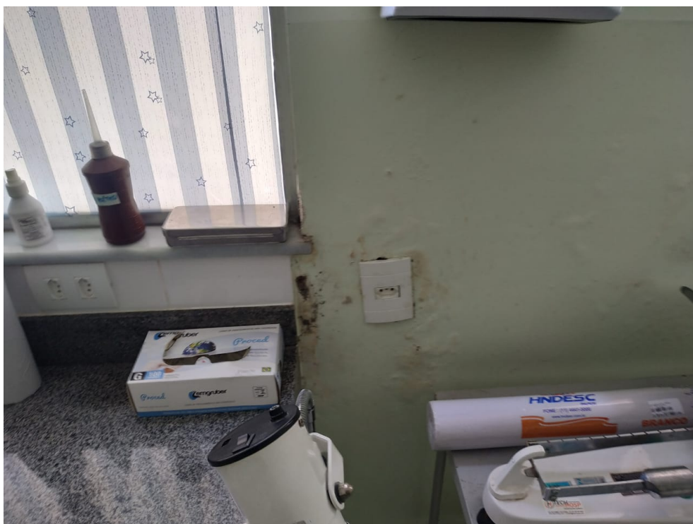
Ponto de mofo e infiltração na parede
