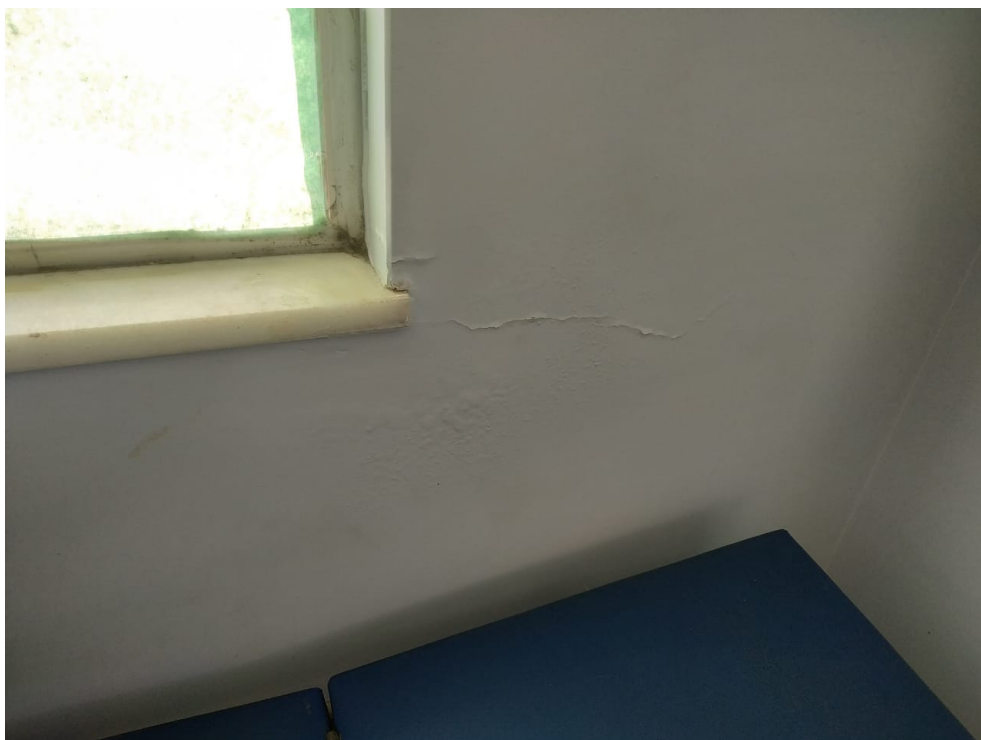
Parede descascada devido à infiltração
