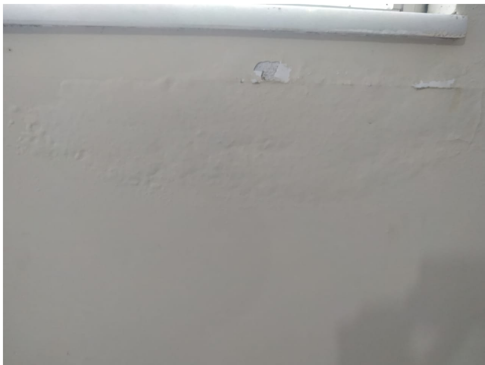
Sala de procedimentos com parede descascando devido às infiltrações
