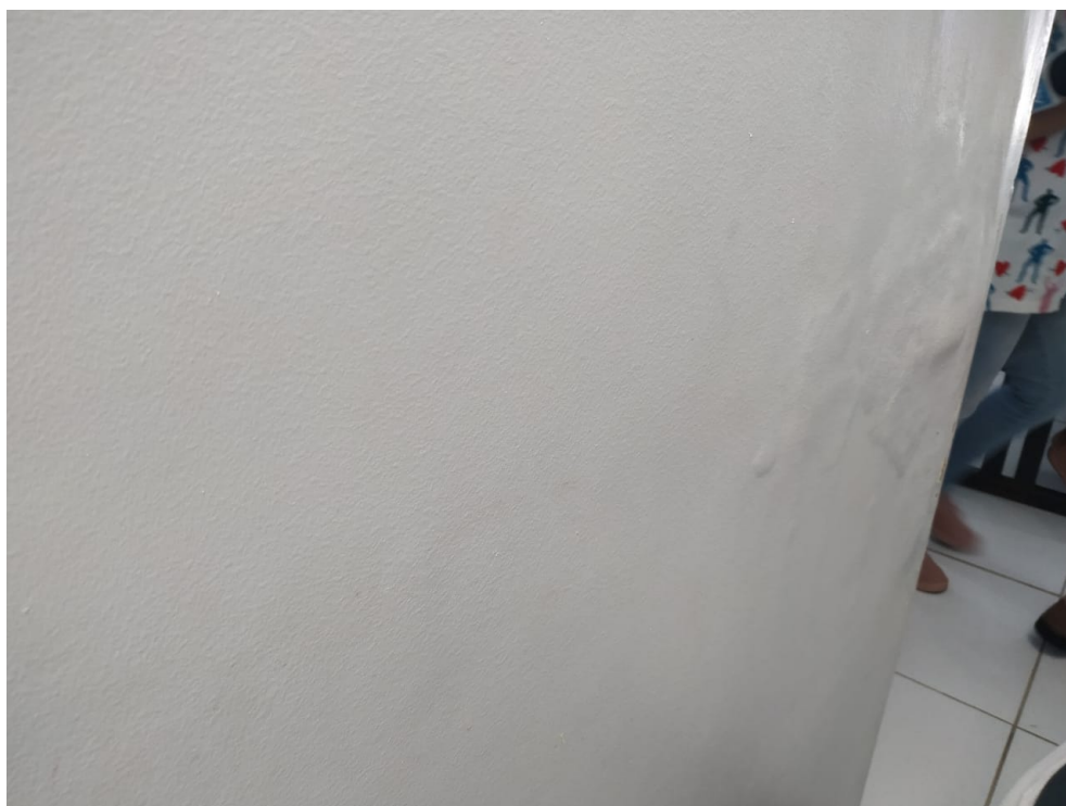
Parede com pintura estufada devido à infiltração
