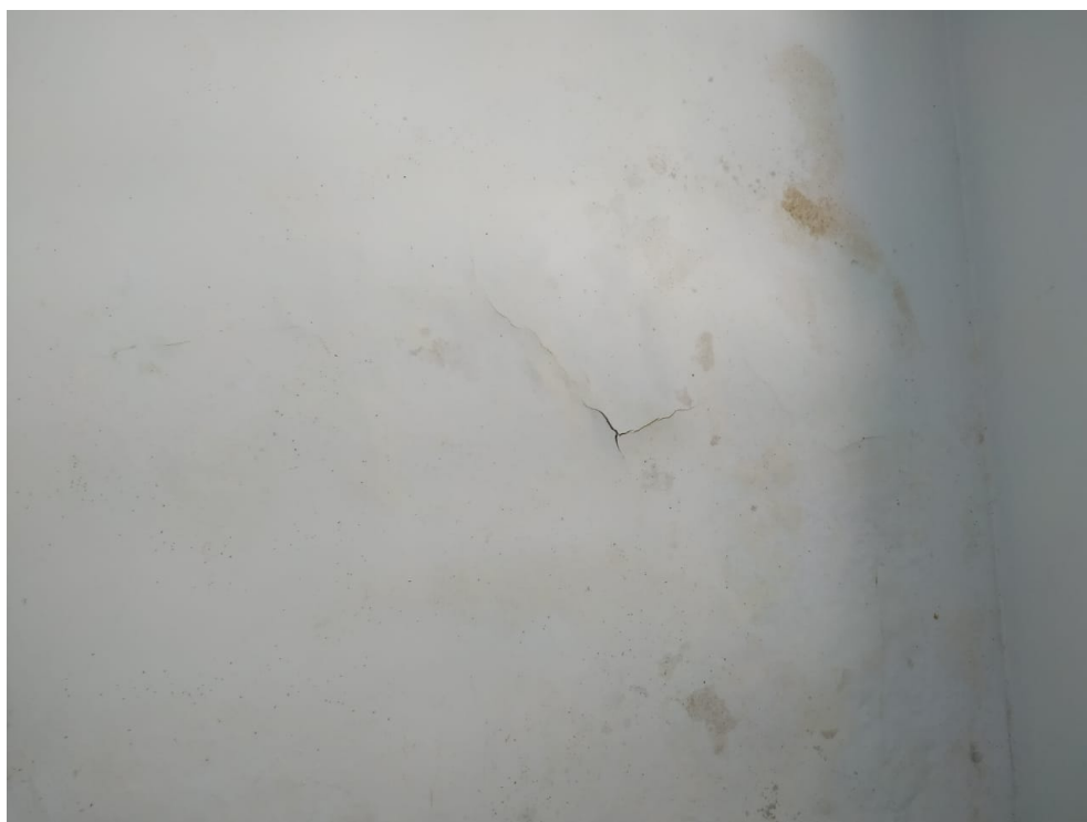
Presença de mofo nas paredes
