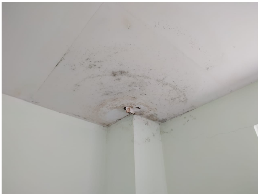
Mofo e infiltração no teto da UBS Dom Bosco
