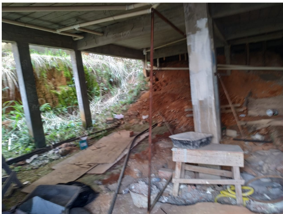
Área correspondente ao subsolo está subutilizada
