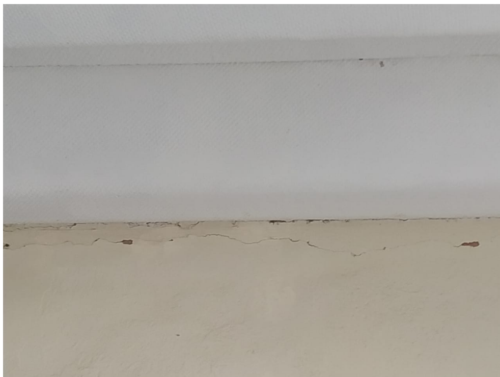
Parede apresenta rachaduras
