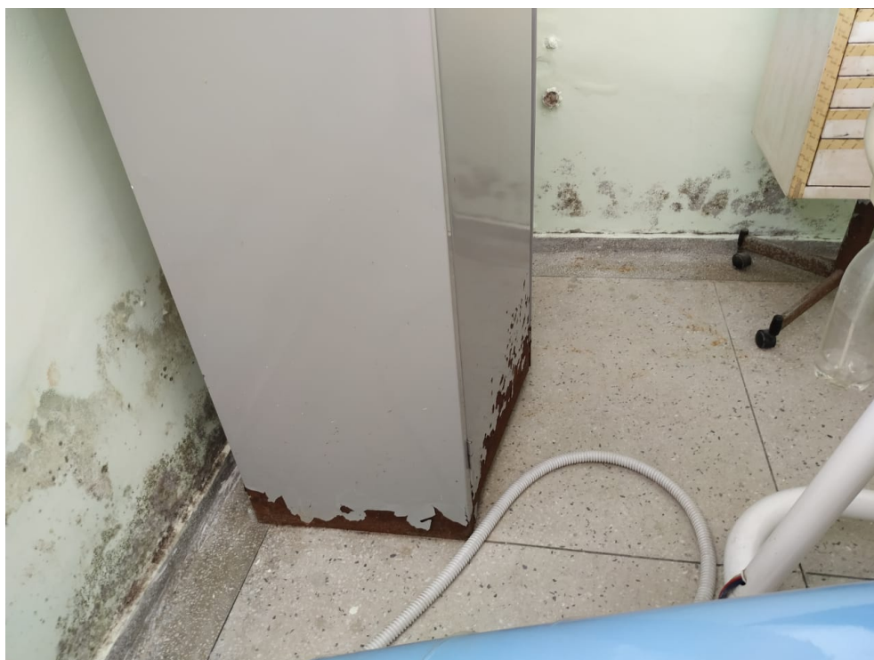
Presença de mofo nas paredes, além de um armário danificado pela ferrugem
