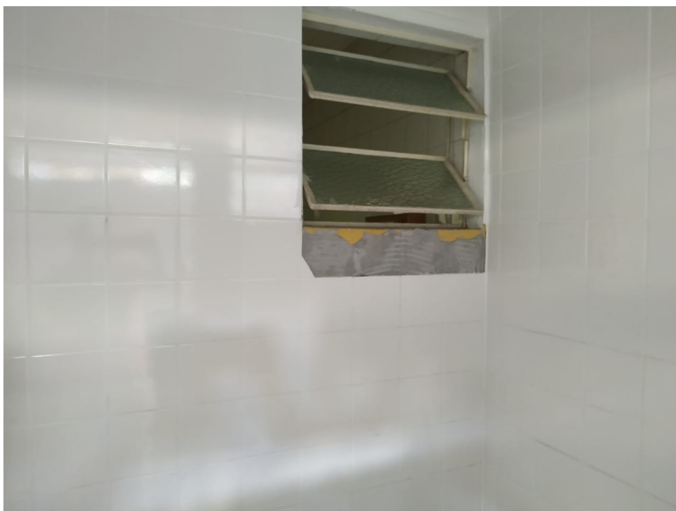
Parede sem azulejos próximo à janela basculante
