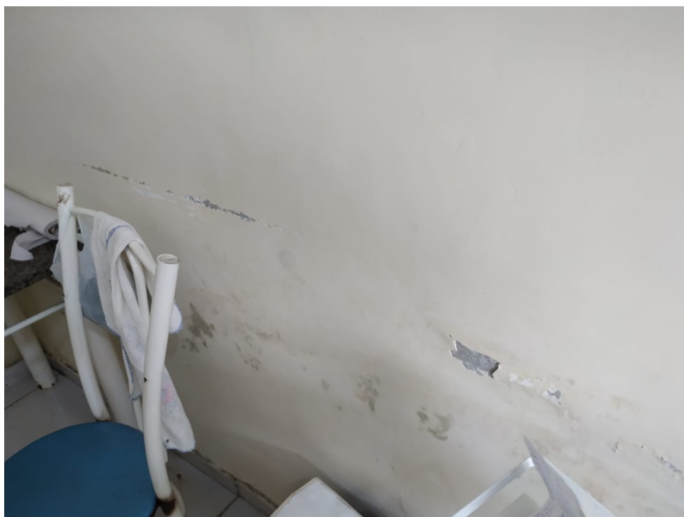
Paredes com presença de mofo e descascando
