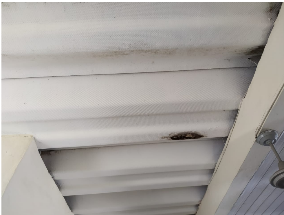
Cobertura inadequada (gera acúmulo de calor)
