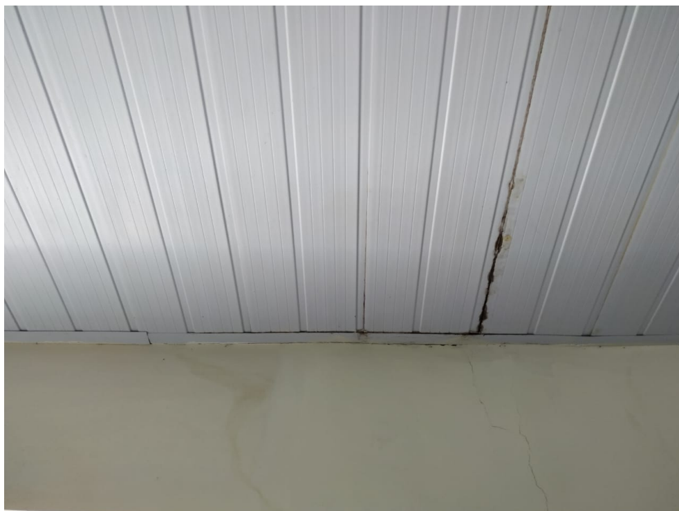
Forro do teto danificado
