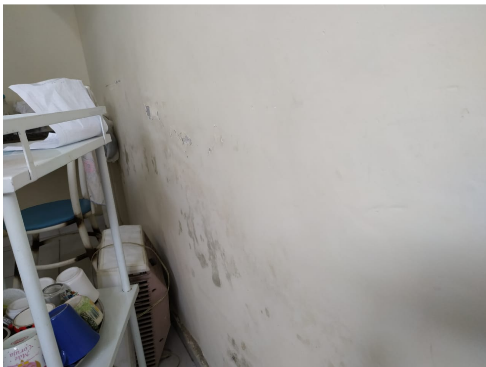
Presença de mofo nas paredes de um dos consultórios
