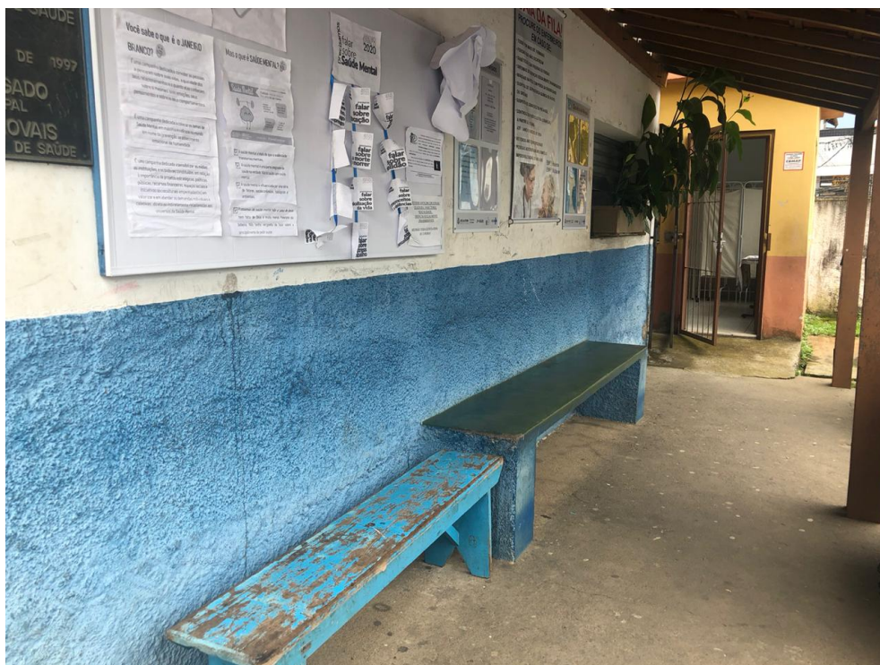
Área de espera reduzida e com assentos inapropriados
