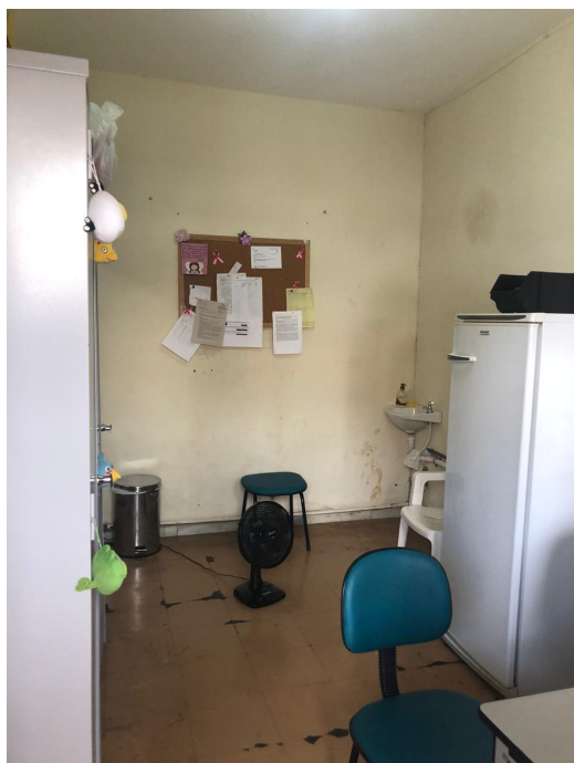
Desgaste no piso e presença de mofo nas paredes
