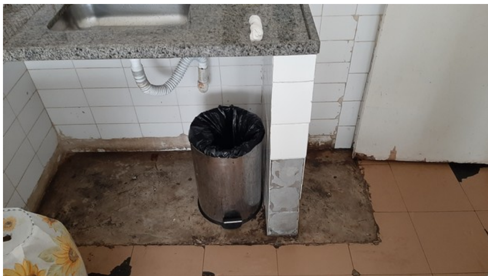
Aspecto do piso e falta de azulejo na estrutura da pia
