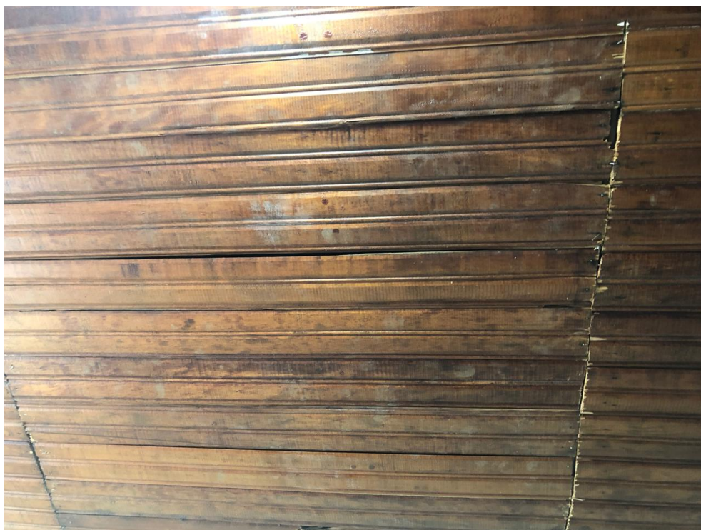
Desgaste no forro do teto e presença de cupim
