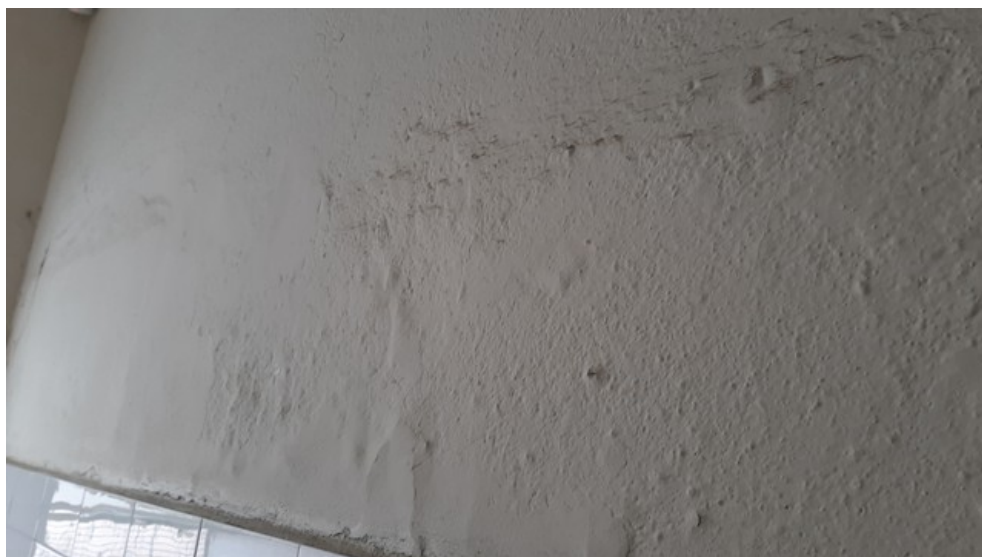
Presença de mofo nas paredes
