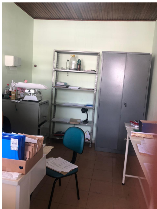
Sala compartilhada com má ventilação e calor excessivo
