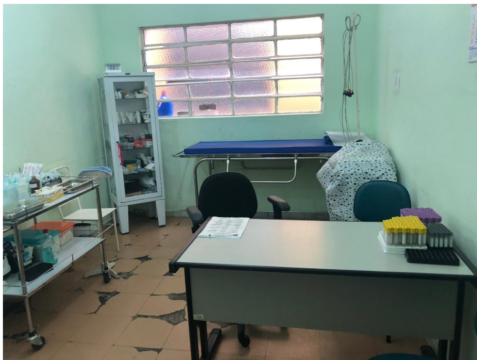
Desgaste no piso do consultório médico
