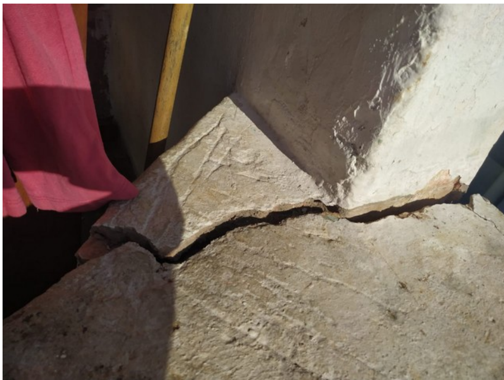
Rachadura em imóvel da Rua José Orozimbo de Oliveira
