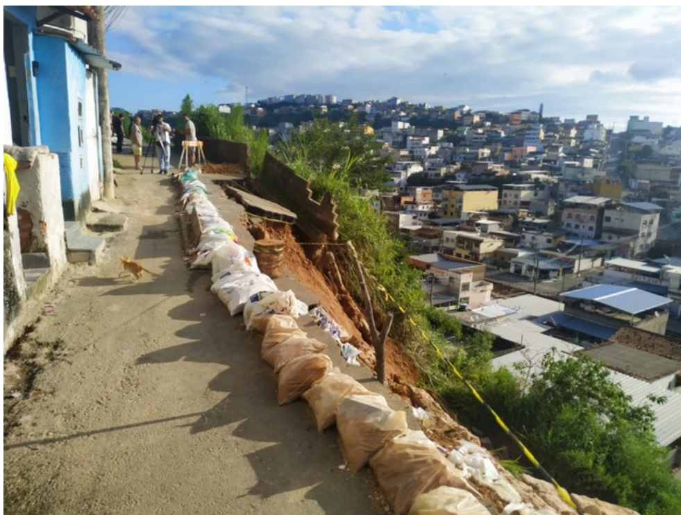
Interdição parcial da rua e risco de comprometimento da estrutura dos imóveis próximos
