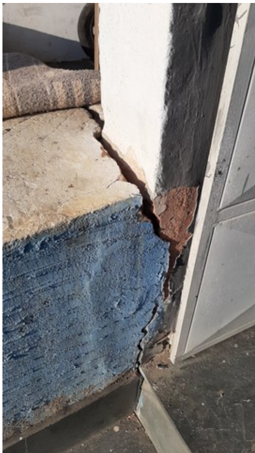
Rachadura em imóvel da Rua José Orozimbo de Oliveira
