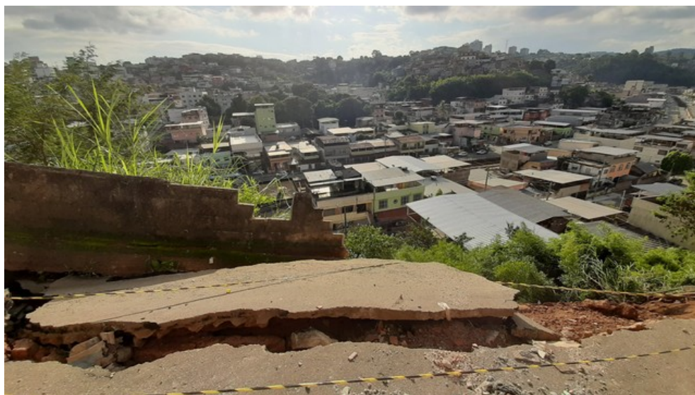
Risco de queda da camada asfáltica e do parapeito
