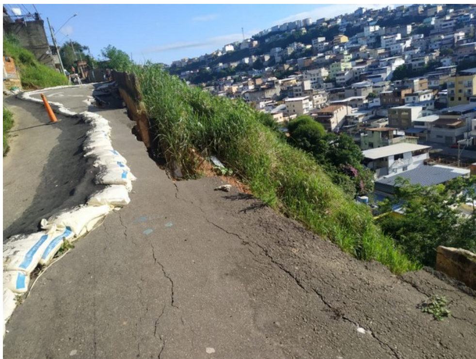
Estrutura da rua comprometida devido ao risco de queda
