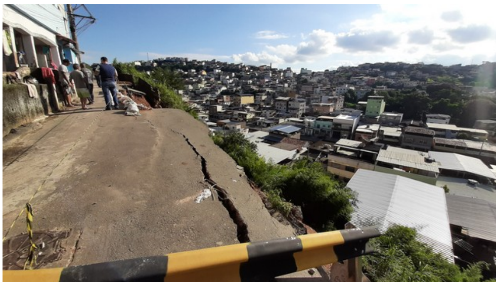
Risco iminente de queda da Rua José Orozimbo de Oliveira
