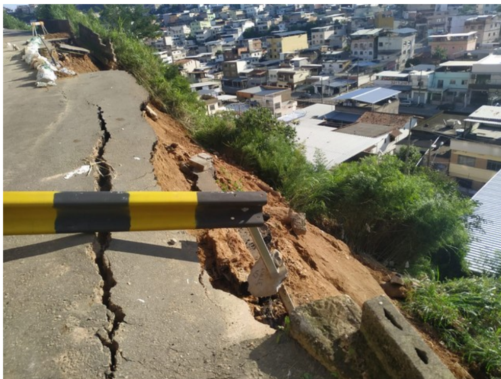
Equipamento de segurança comprometido pela queda parcial da rua
