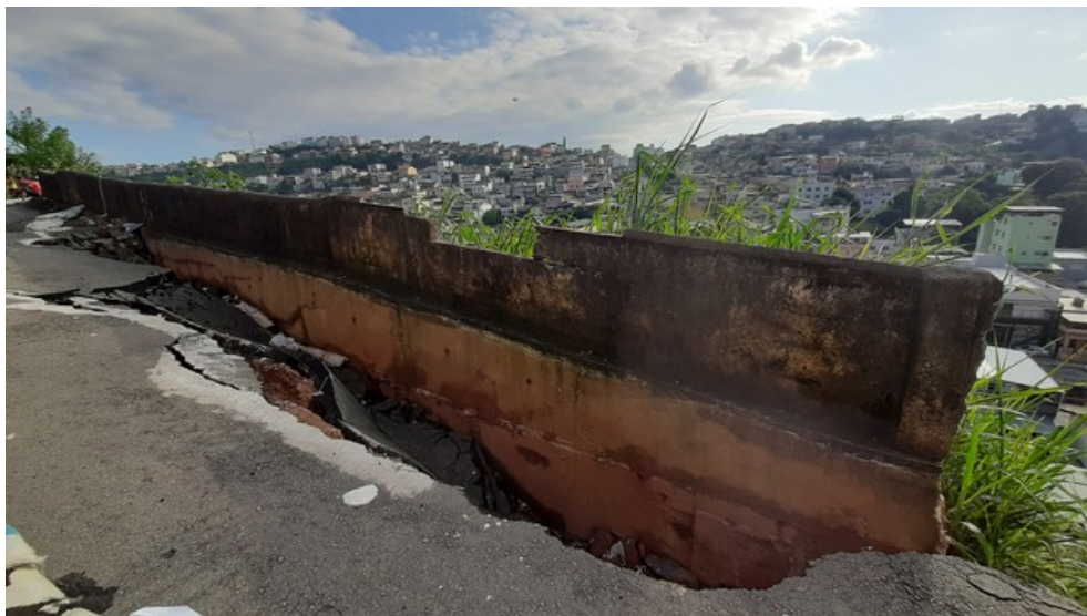
Aspecto de trecho comprometido na rua
