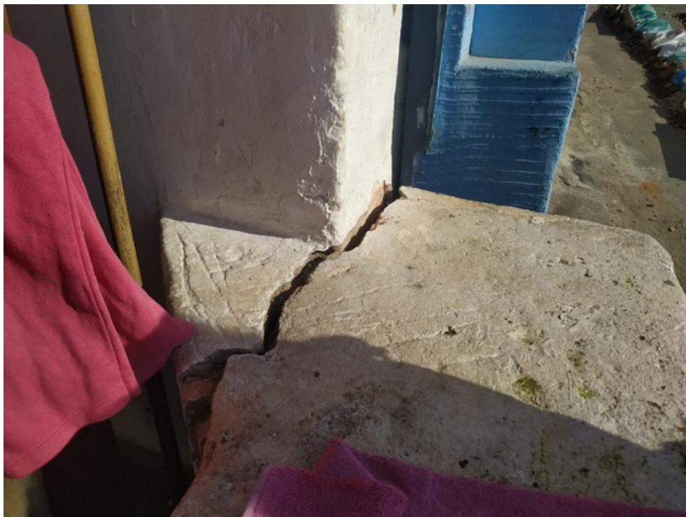
Rachadura em imóvel na Rua José Orozimbo de Oliveira
