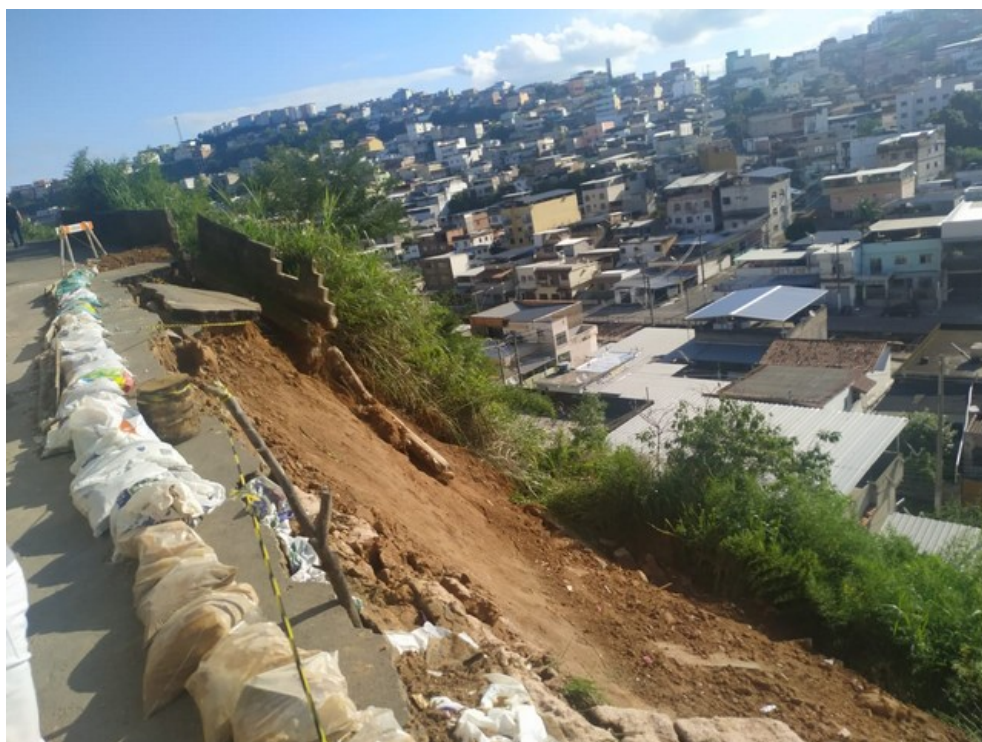
Parte da rua e muro cedidos na Rua José Orozimbo de Oliveira
