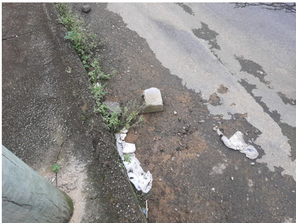
Presença de detritos ao longo da via
