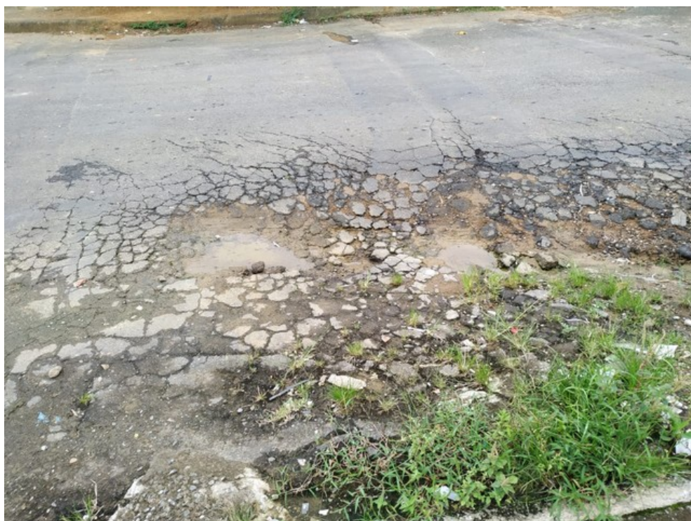
Presença de buracos na via e ausência de capina adequada
