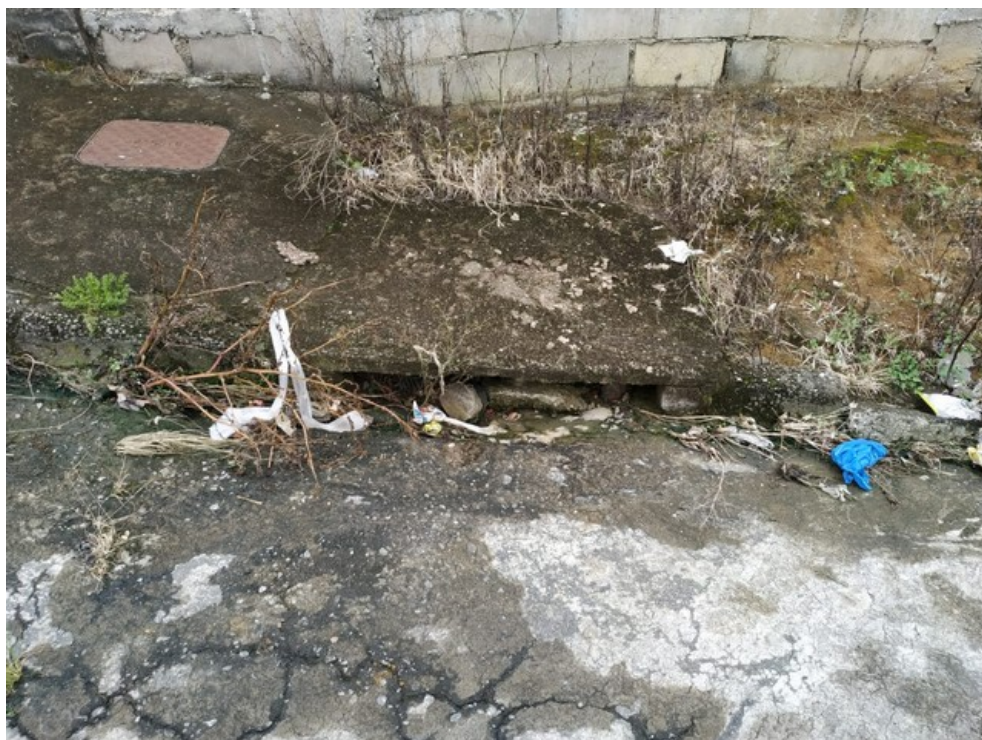
Bocas de lobo estreitas e repletas de lixo
