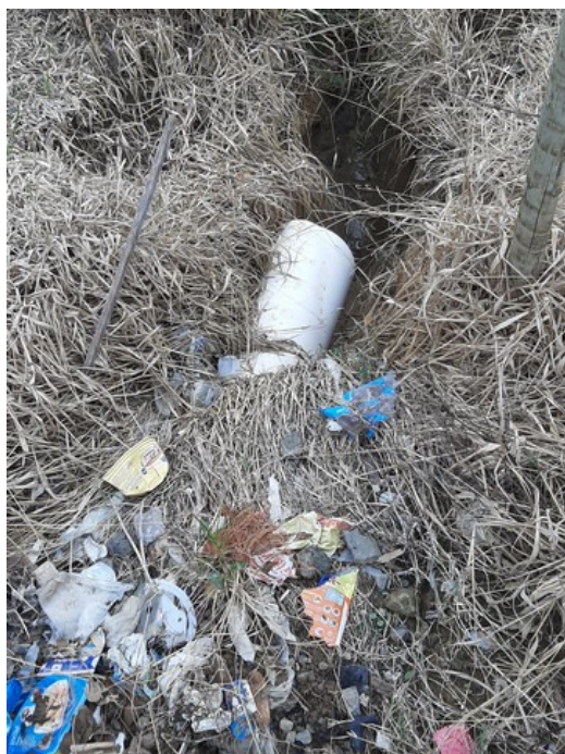
Presença de lixo no local
