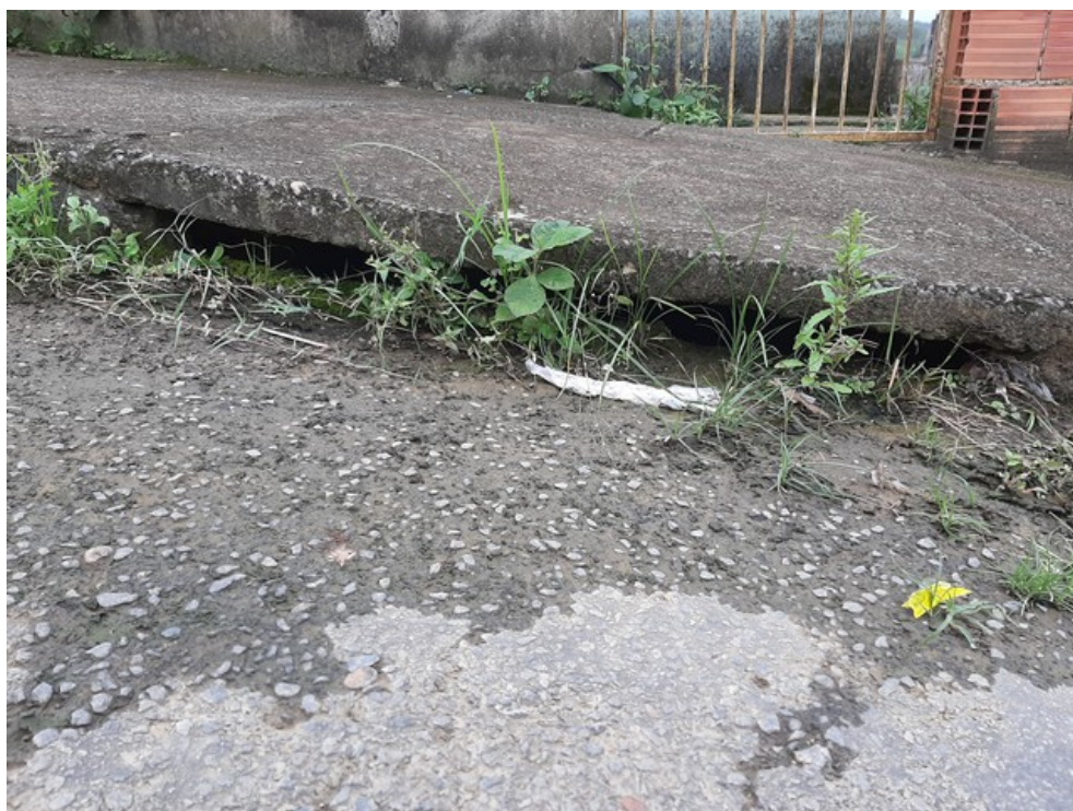
Bueiro assoreado e sem capina
