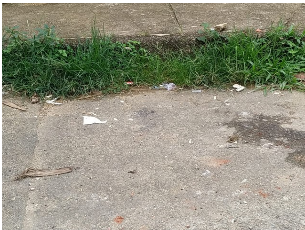
Falta de capina adequada na via
