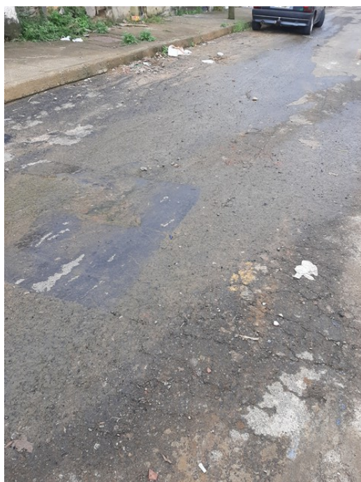
Presença de esgoto ao longo da via
