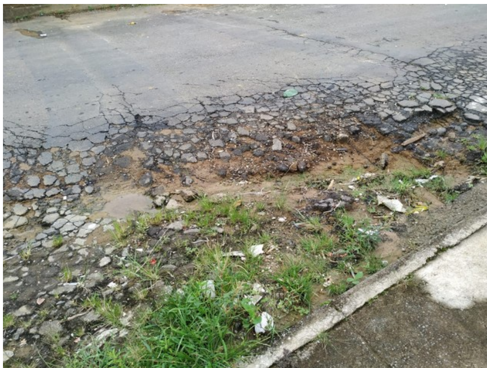
Falta de capina adequada na via
