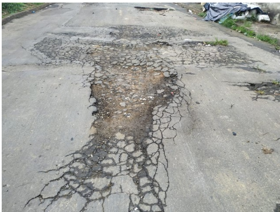
Asfalto em más condições
