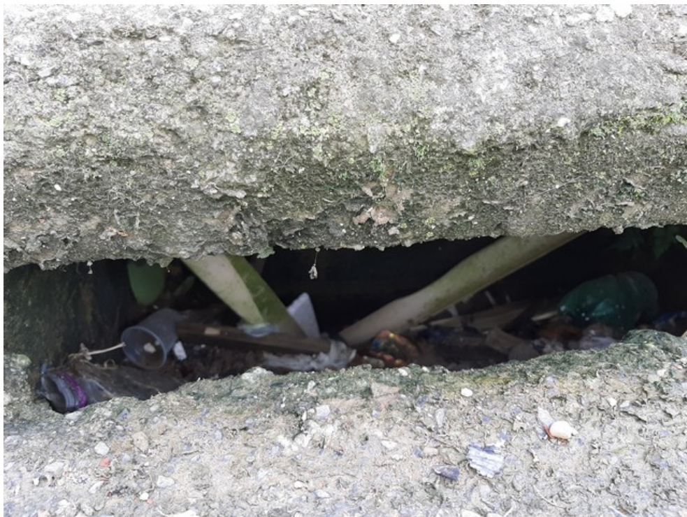
Presença de lixo em um dos bueiros do Loteamento Porto Seguro
