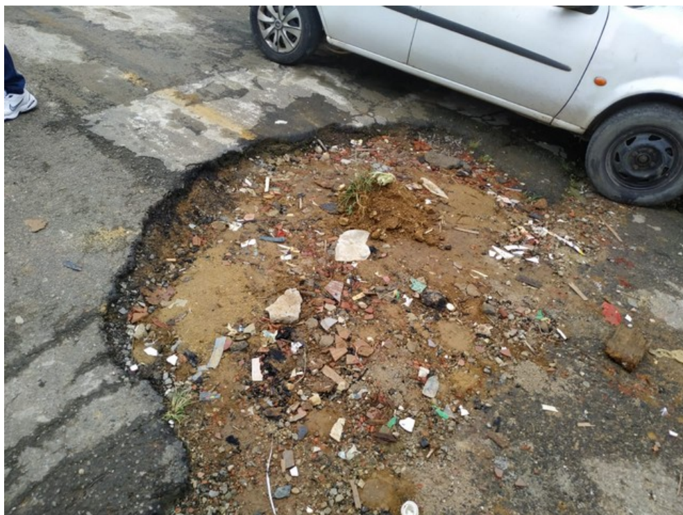
Buraco na rua Antônio Barezi
