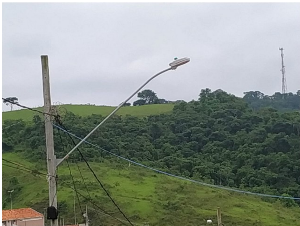
Poste de iluminação inoperante
