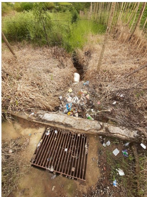
Presença de lixo em um dos bueiros do Loteamento Porto Seguro
