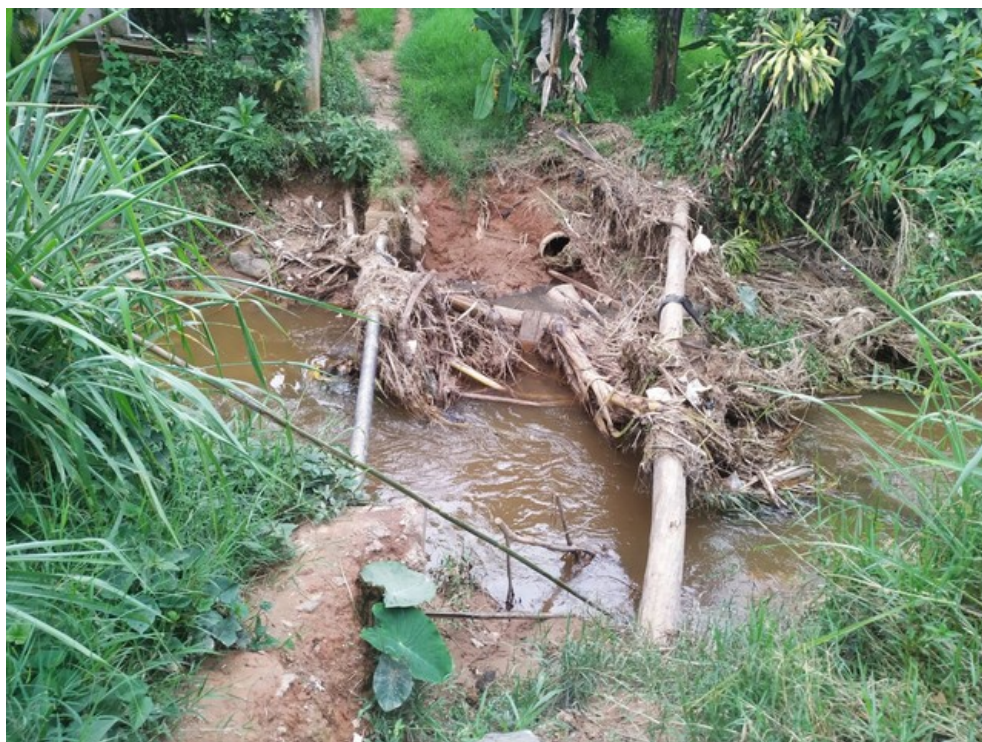
Excesso de resíduos sólidos próximo à antiga ponte entre as ruas G e A.K. Duque
