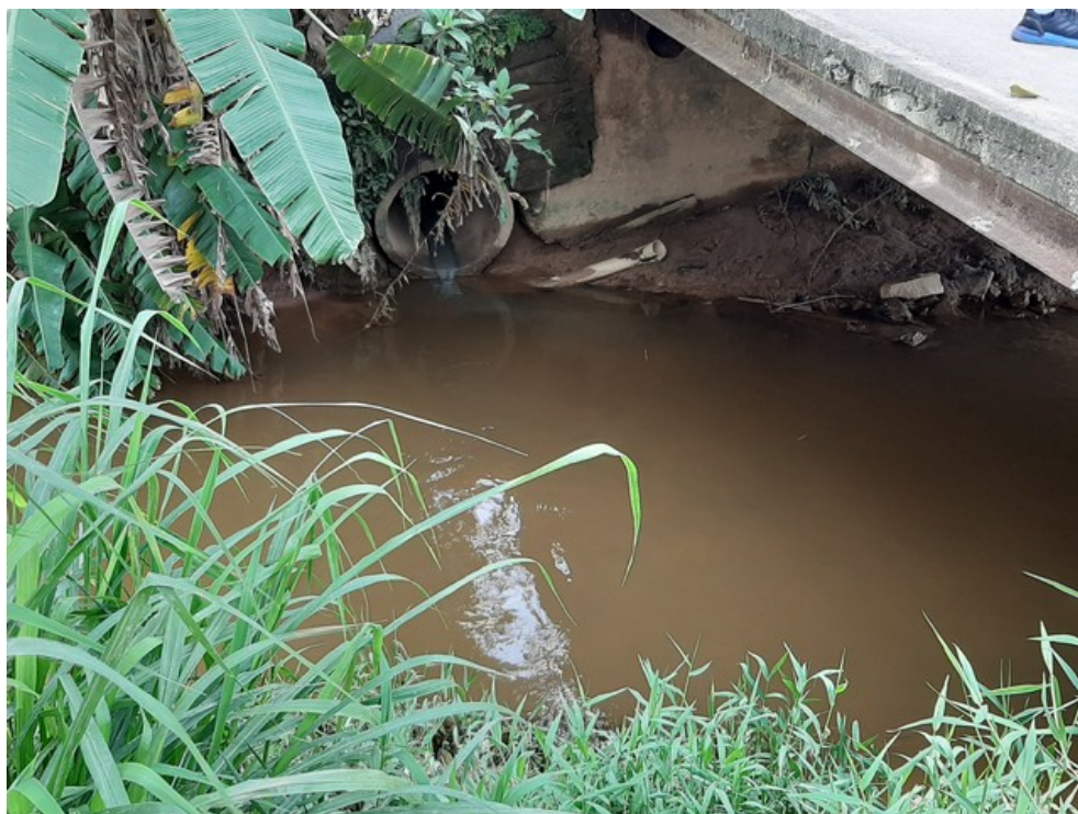
Assoreamento no leito do Córrego Três Pontes
