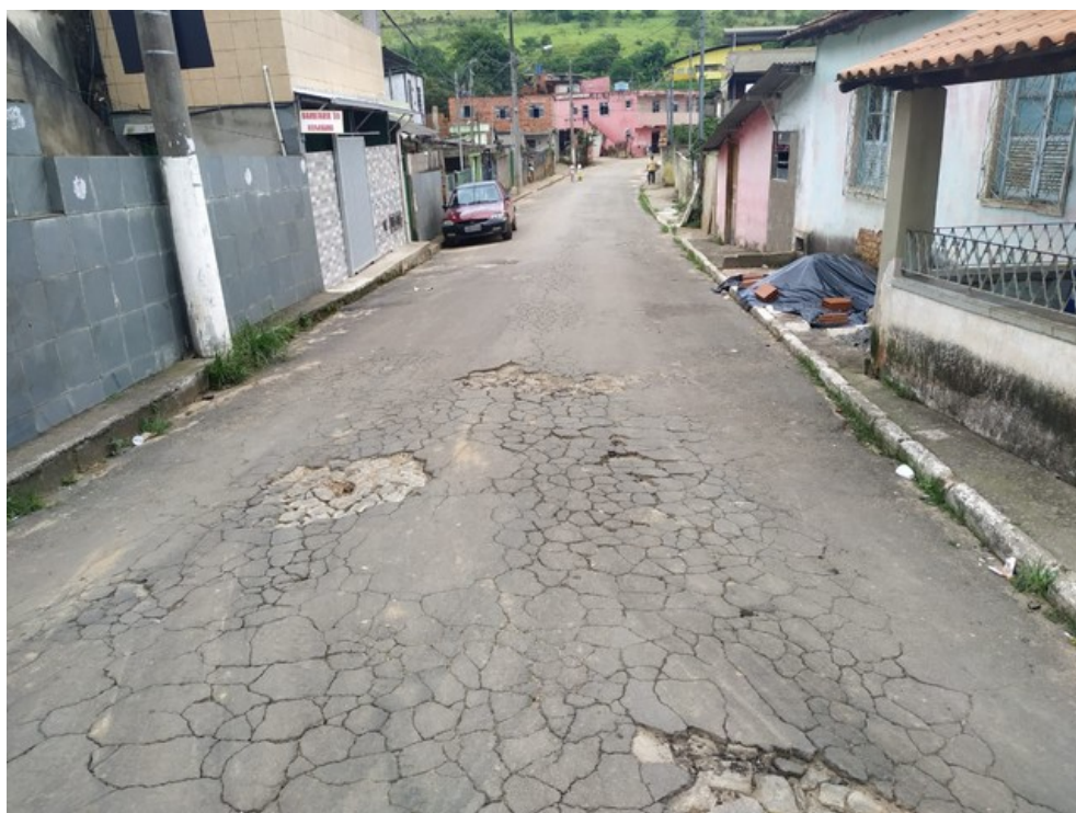
Presença de diversos buracos ao longo da Rua B
