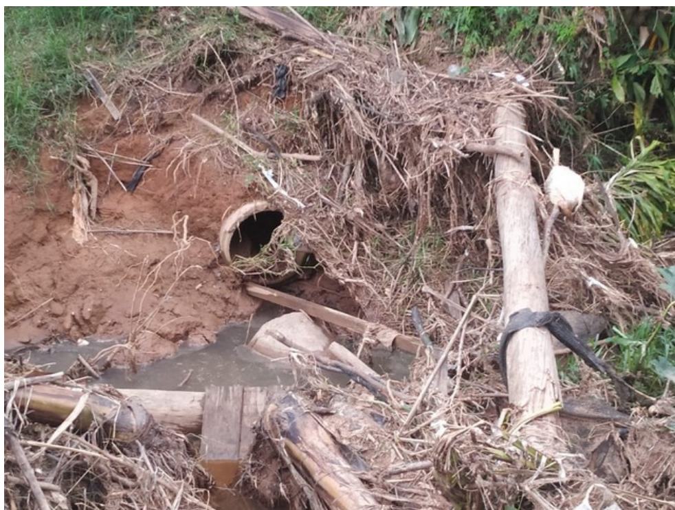
Excesso de resíduos sólidos descartados no Córrego Três Pontes
