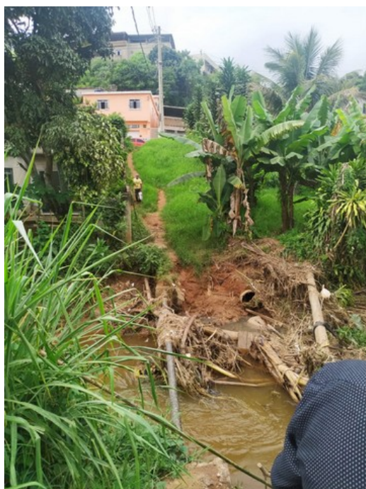
Destruição na área da antiga ponte entre as ruas G e A. K. Duque
