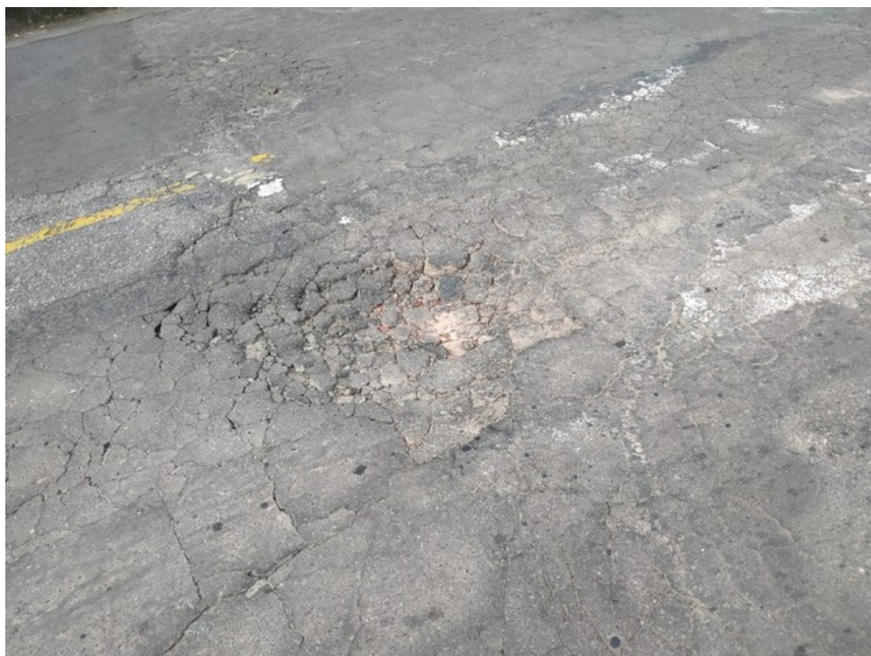
Presença de buracos no trecho
