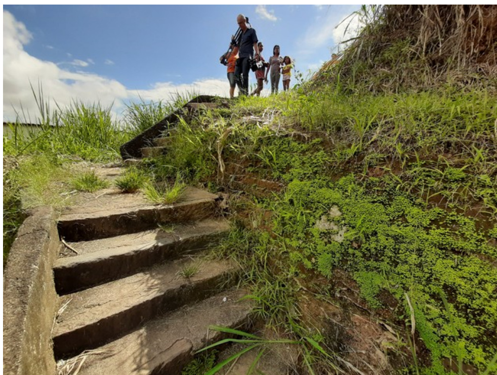
Falta de capina no escadão de acesso
