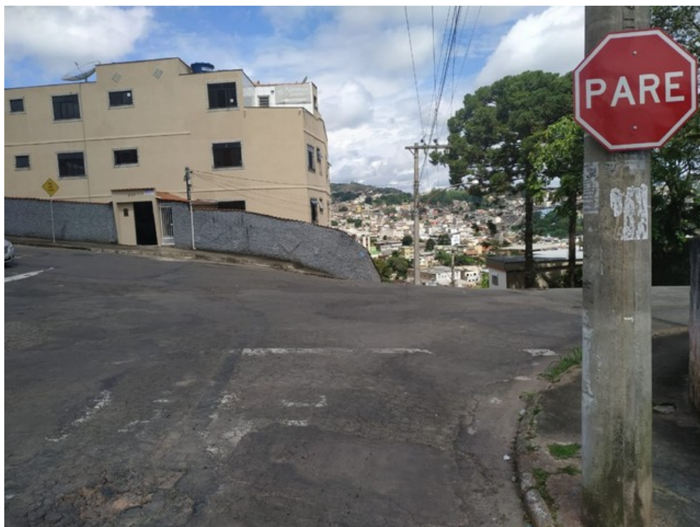
Sinalização horizontal apagada no cruzamento das ruas Santana e Alves Júnior
