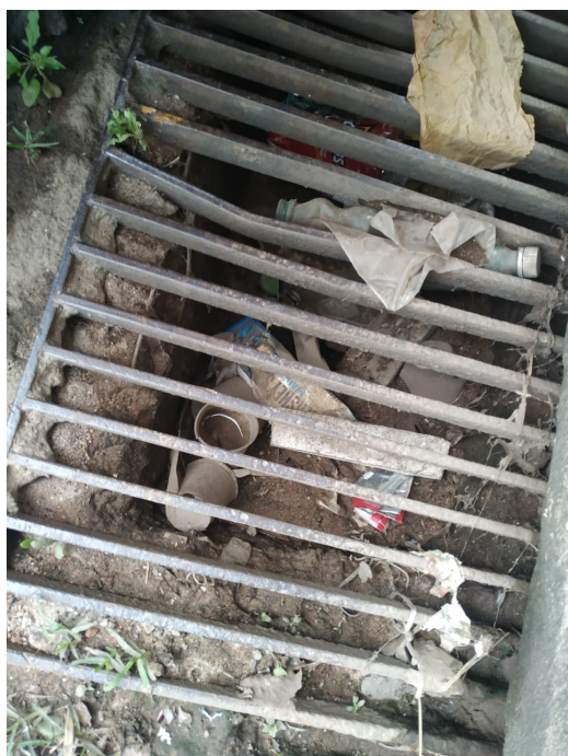
Boca de lobo com excesso de resíduos sólidos em seu interior
