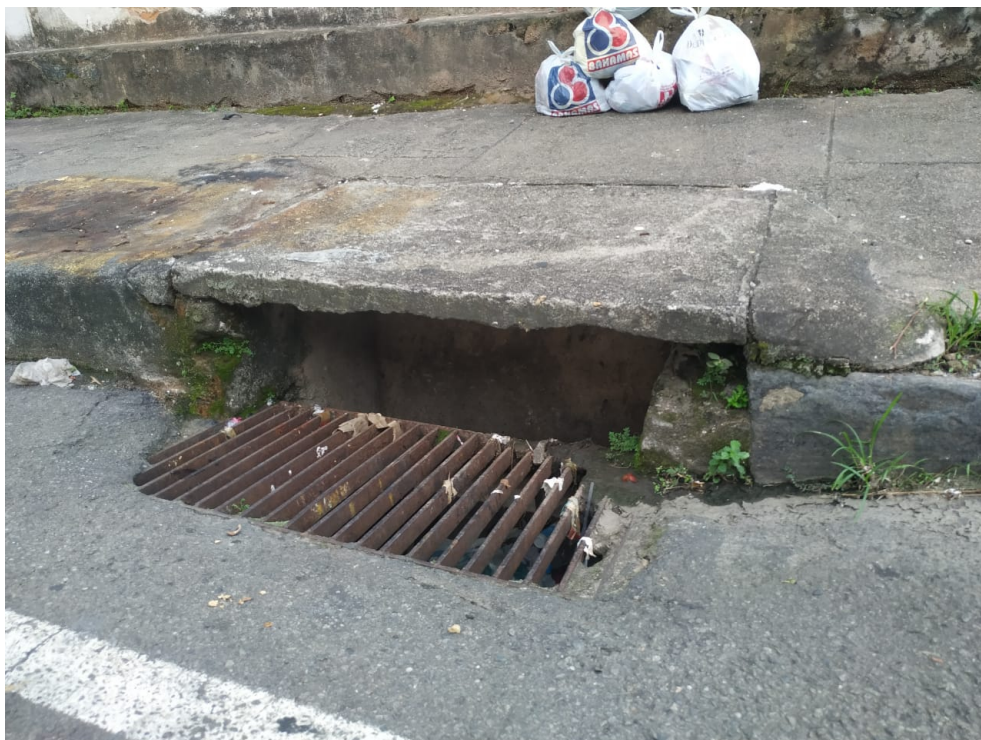
Descarte de lixo irregular ao longo da via
