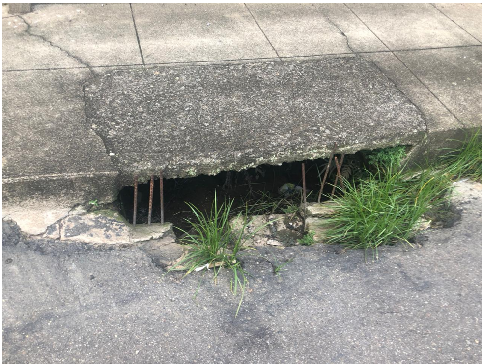
Boca de lobo com gradil danificado
