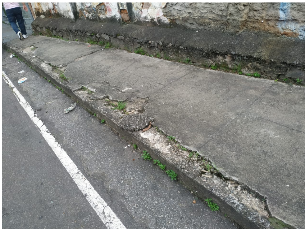
Calçadas em mau estado de conservação
