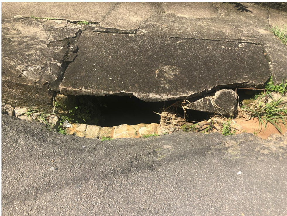
Boca de lobo com tampa quebrada
