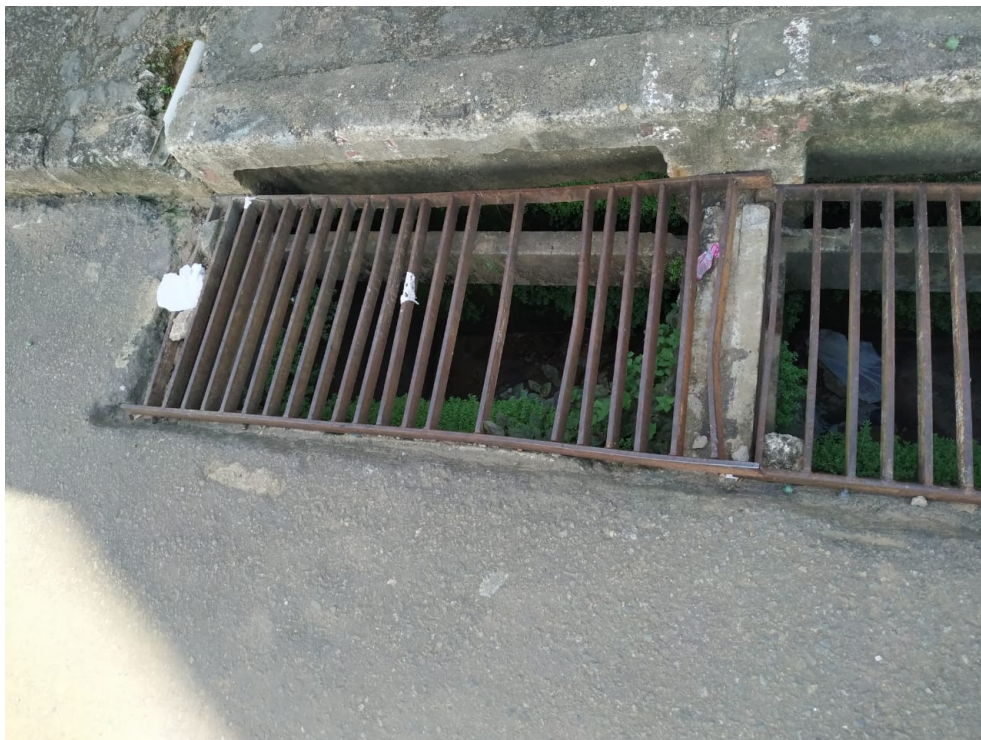
Boca de lobo estreita e gradil danificado
