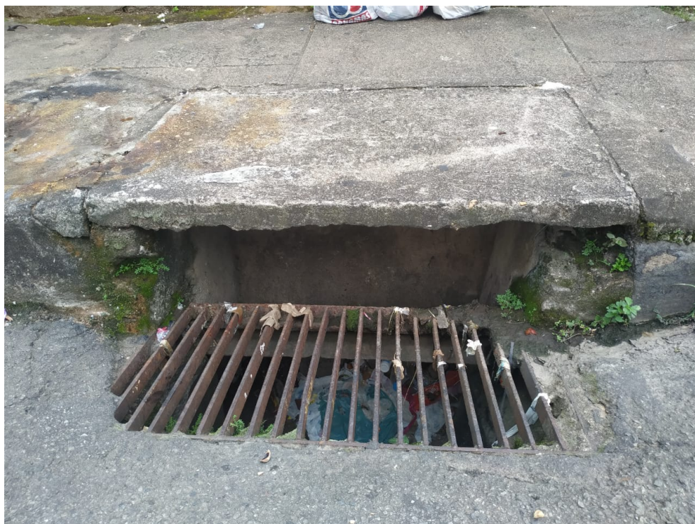
Boca de lobo com excesso de resíduos sólidos em seu interior
