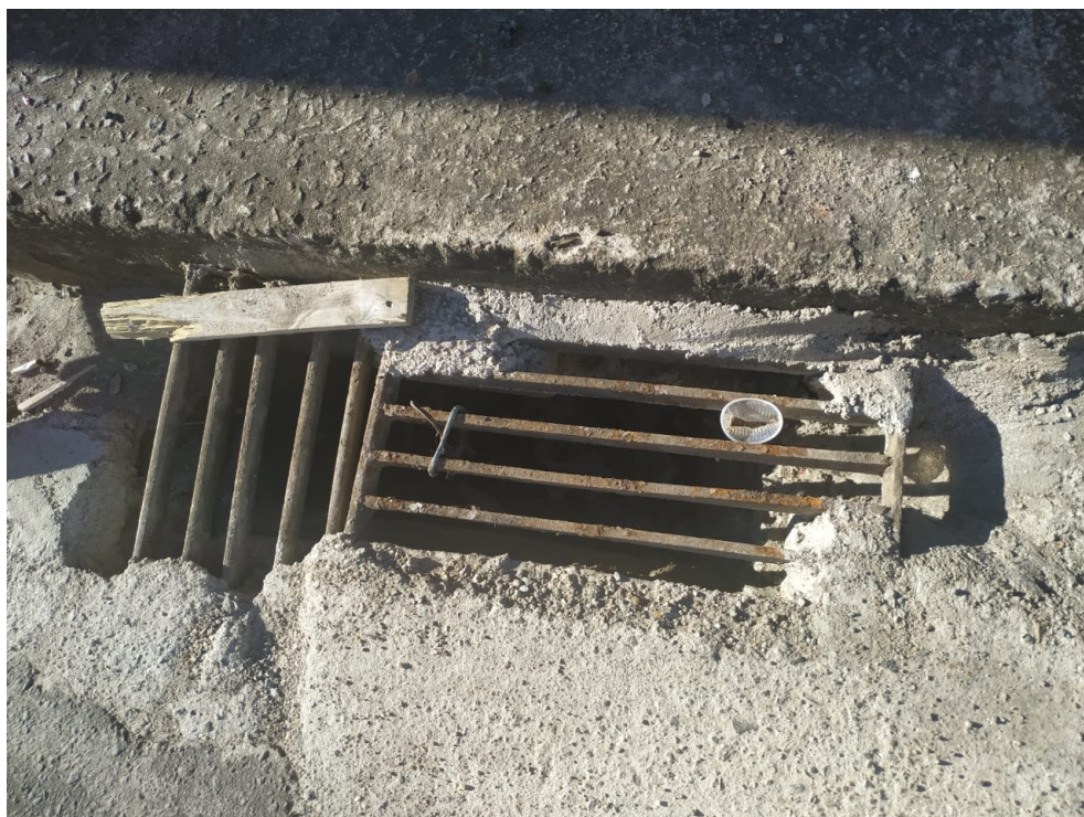
Bueiro na Rua Américo Lobo (baixa capacidade de vazão)
