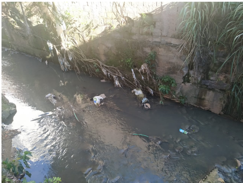
Acúmulo de detritos no leito do Córrego Matirumbide
