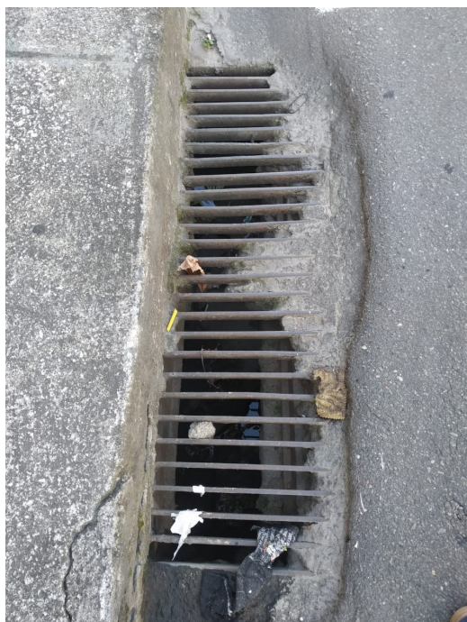
Bueiro na Rua Américo Lobo (baixa capacidade de vazão)
