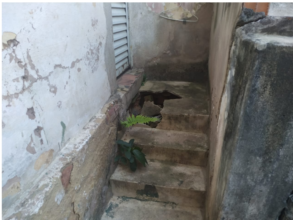
Dano no interior de uma residência registrado após a enchente do dia 24 de dezembro de
