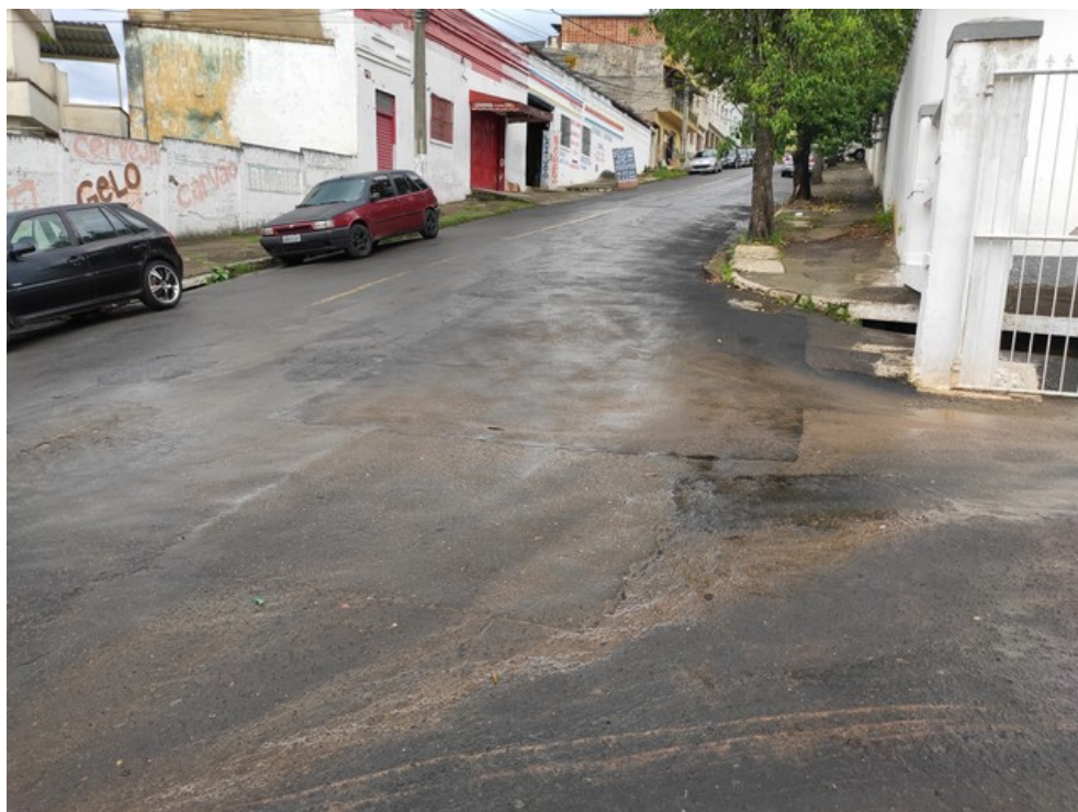
Entrada do cemitério sem faixa de pedestres
