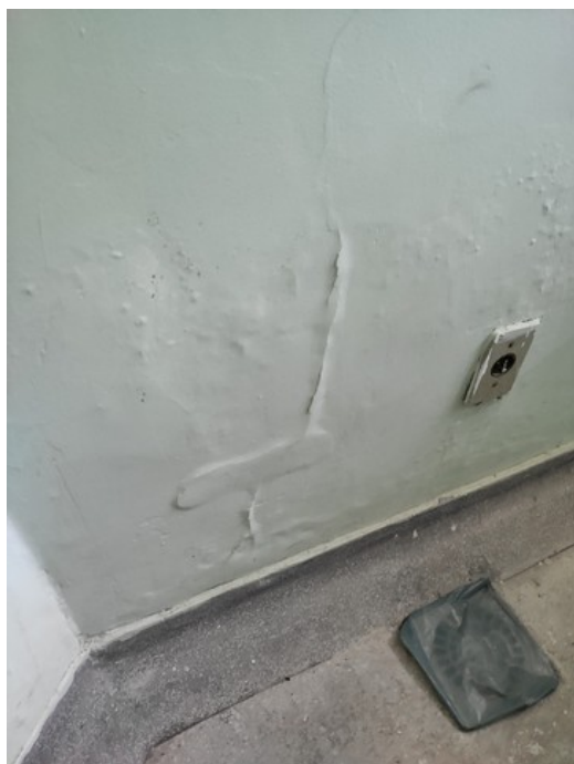
Infiltração no consultório odontológico
