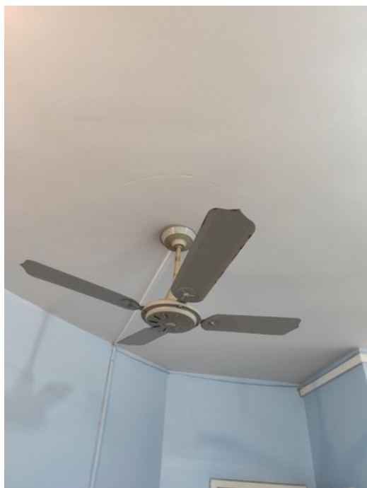
Ventilador com defeito na recepção
