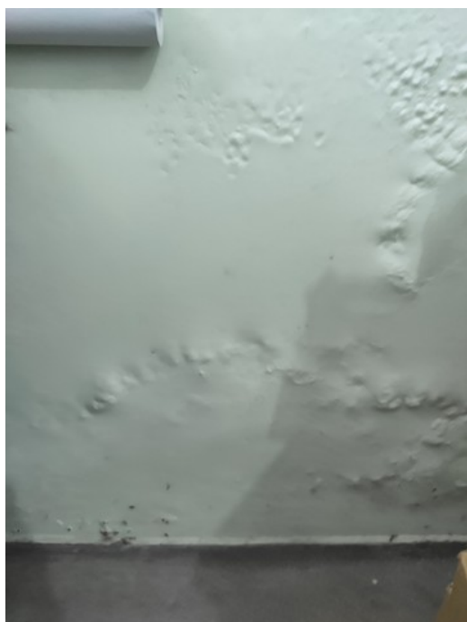
Infiltração em um consultório
