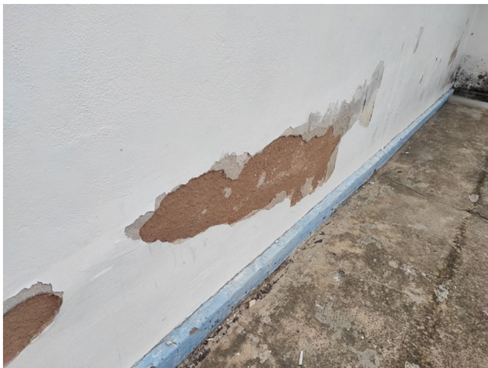
Parede descascada na área externa
