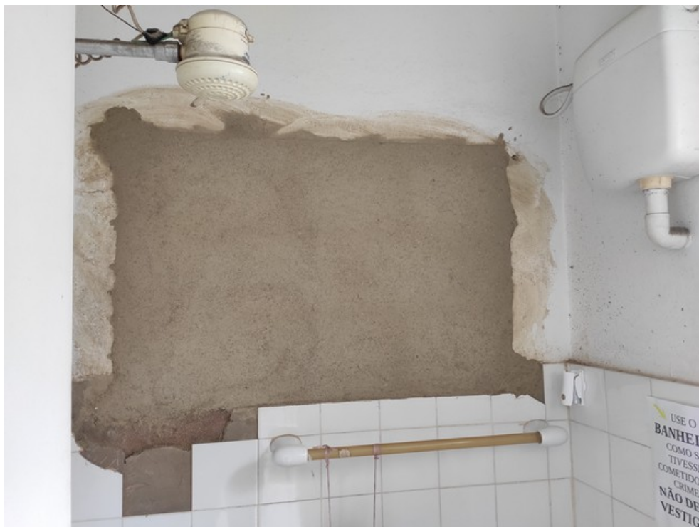
Banheiro dos funcionários sem acabamento
