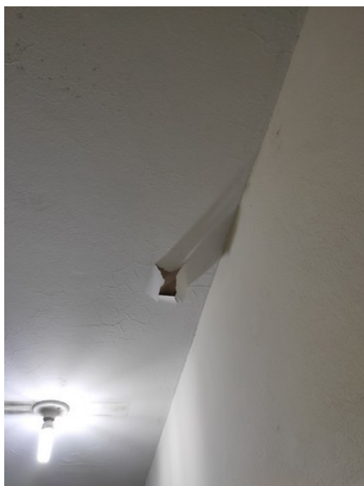
Teto descascado no corredor da unidade
