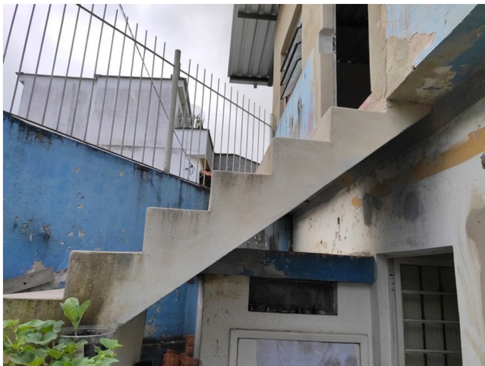
Escada de acesso ao segundo andar sem corrimão
