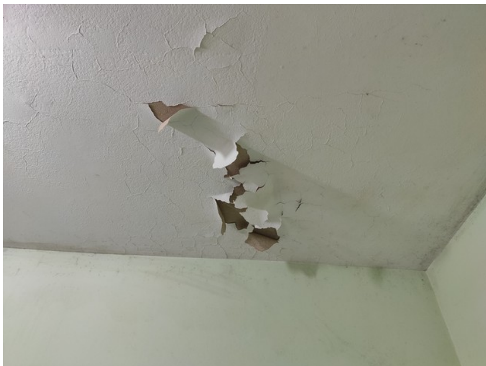
Teto descascado em um consultório
