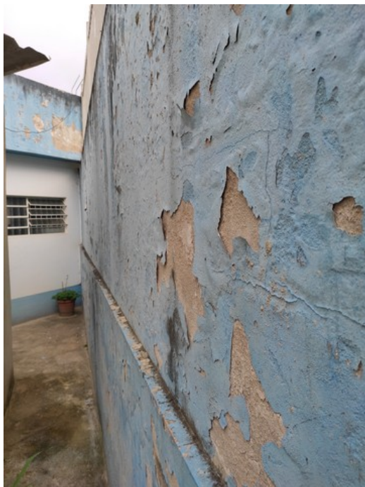
Parede descascada nos fundos da unidade
