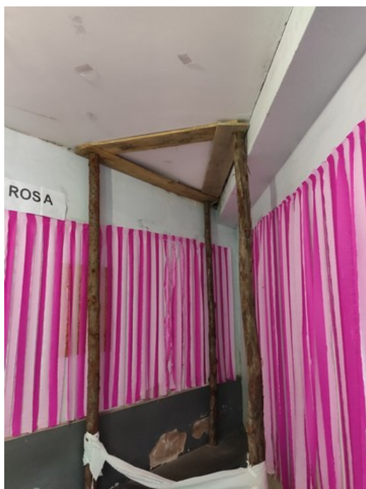
Sustentação improvisada do teto da recepção
