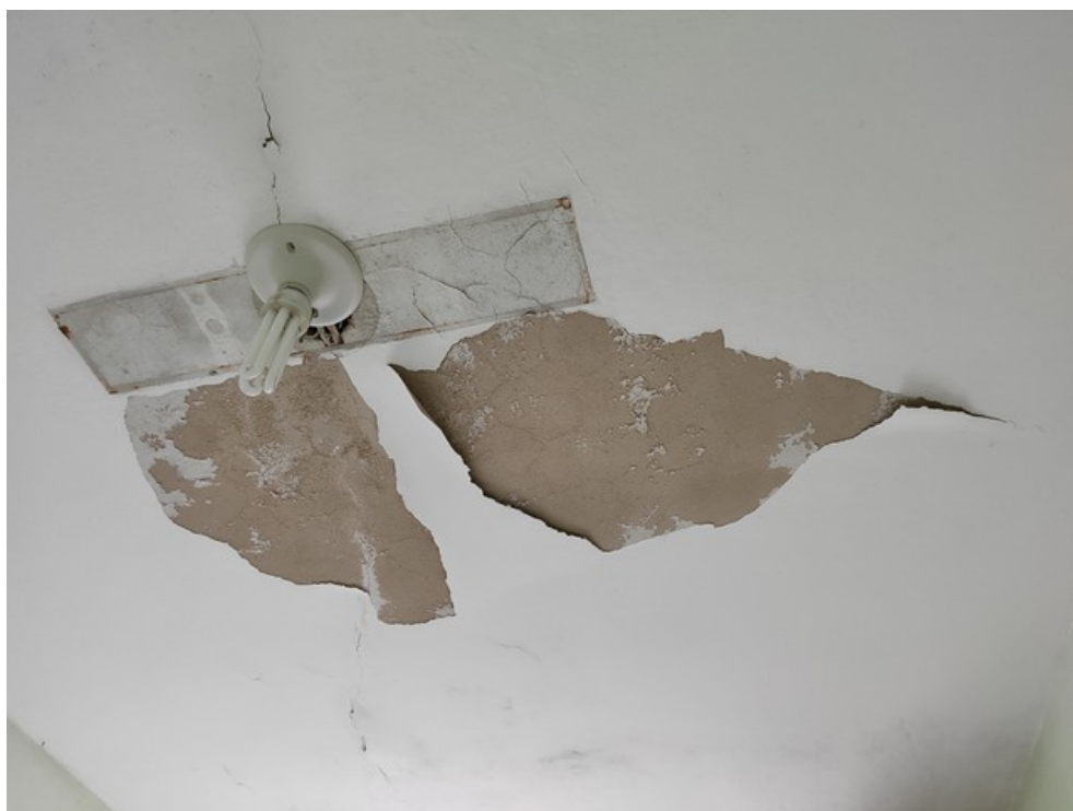
Teto descascado na sala dos agentes comunitários de saúde
