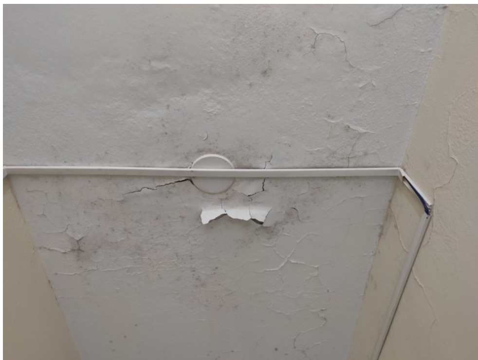
Teto descascado no corredor da unidade
