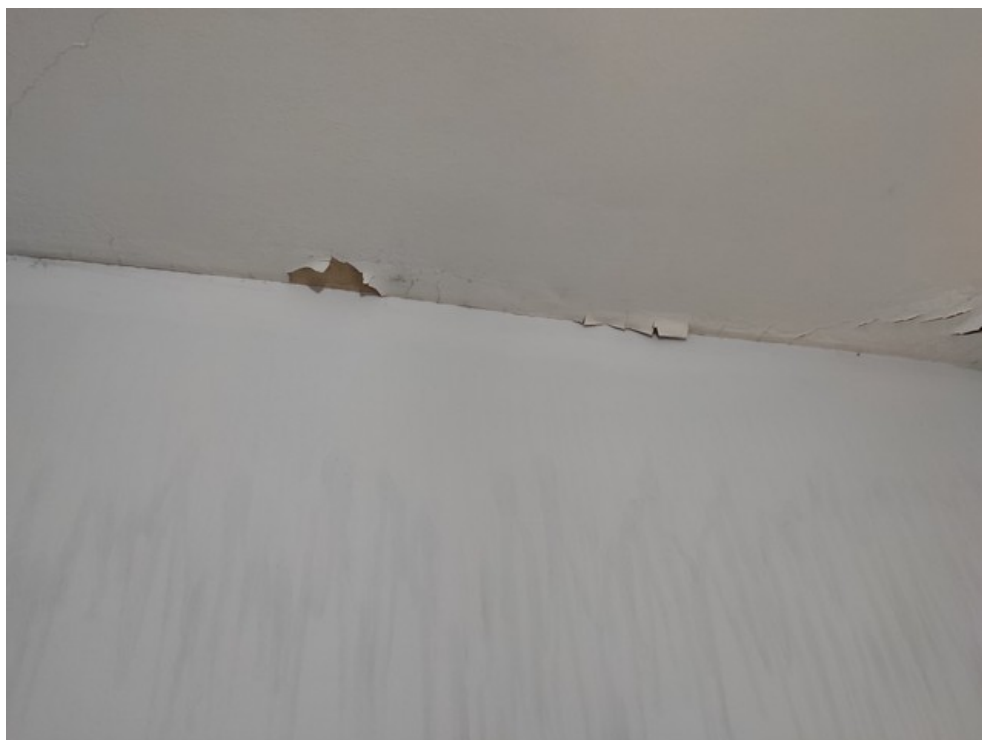
Infiltração na sala de vacina
