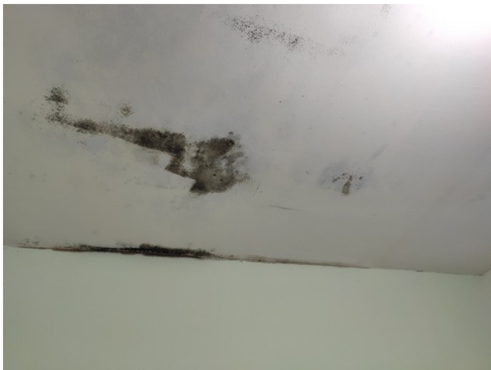
Mofo na sala de procedimentos de enfermagem
