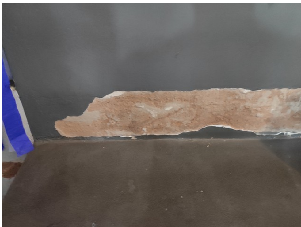
Paredes descascadas na recepção
