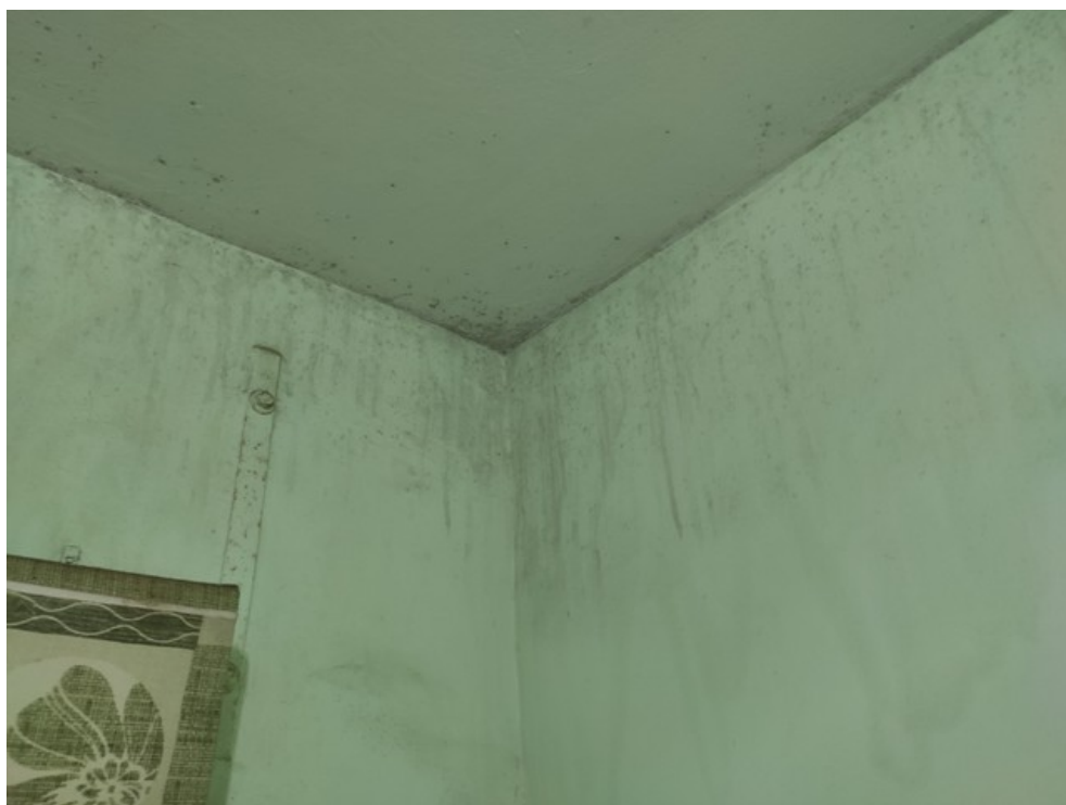
Infiltração em um dos consultórios
