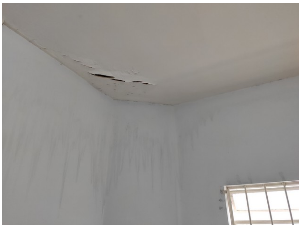
Infiltração na sala de vacina
