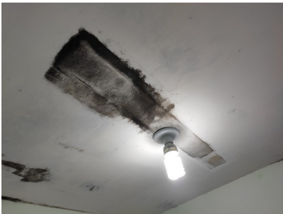
Mofo na sala de procedimentos de enfermagem
