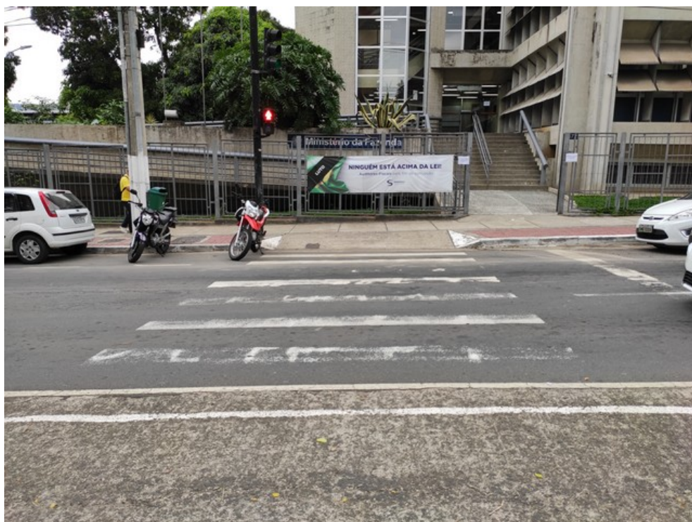
Faixa de pedestres necessitando de reforço na pintura na Av. Rio Branco, 372
