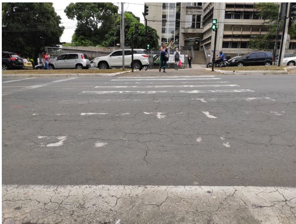
Faixa de pedestres necessitando de reforço na pintura na Av. Rio Branco, 385
