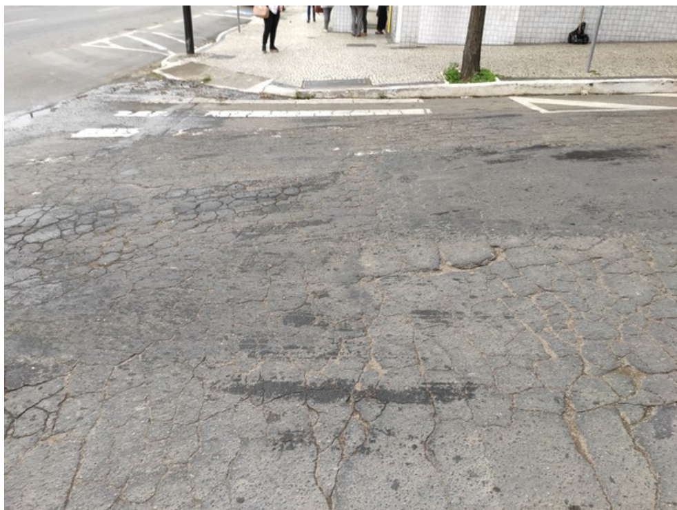
Faixa de pedestres apagada na Rua Sergipe
