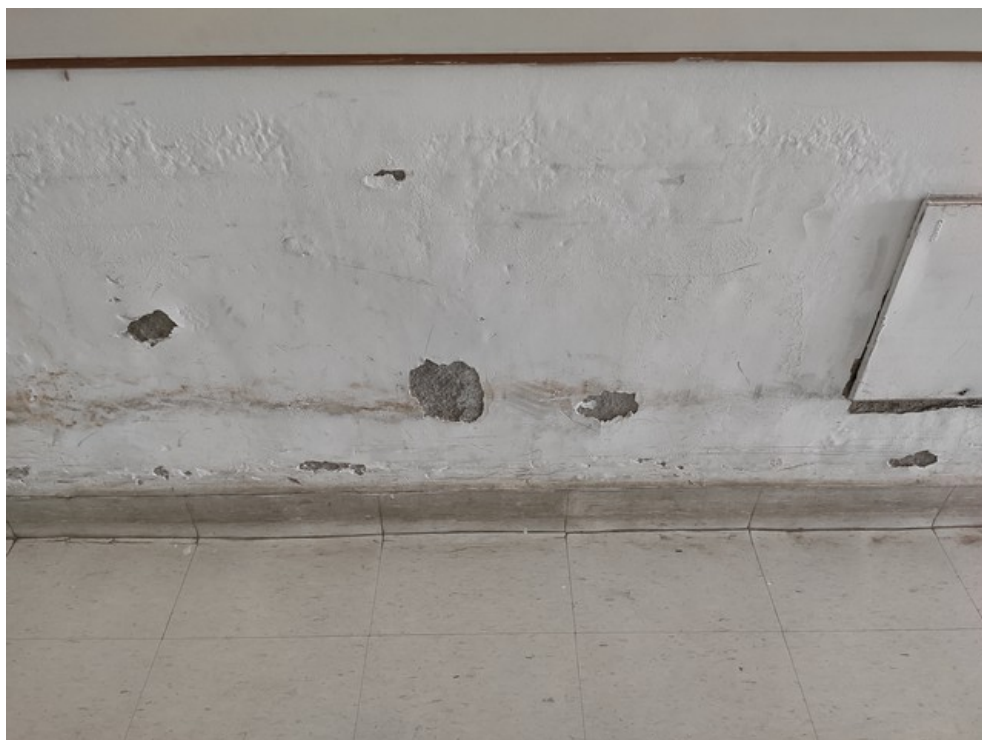
Parede descascada no corredor
