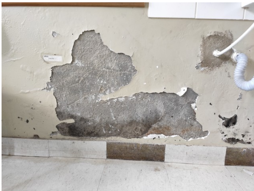
Parede descascada na Observação Adulta Feminina
