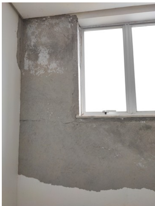
Parede descascada no Consultório de Pediatria
