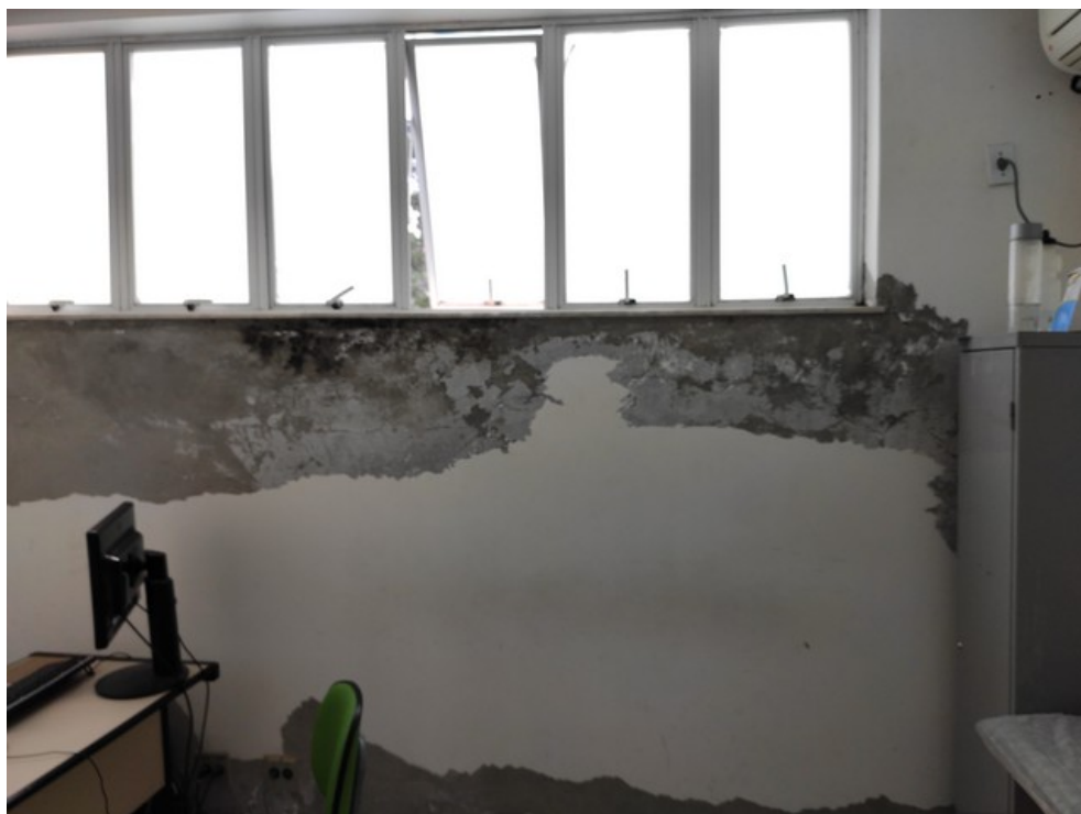
Parede descascada e mofo no Consultório de Pediatria
