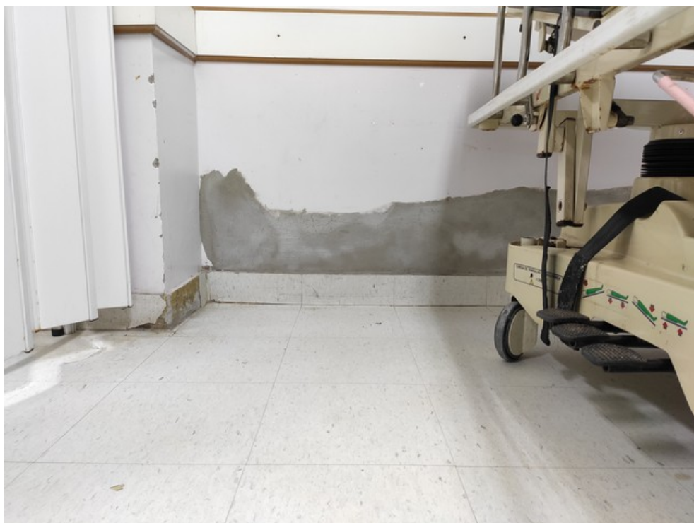
Parede descascada no setor de urgência
