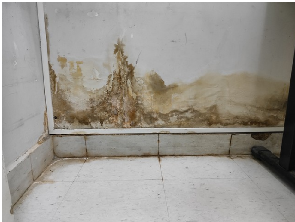
Buraco na parede causado por infiltração na Câmara Escura, na sala de Imagem e Radiologia
