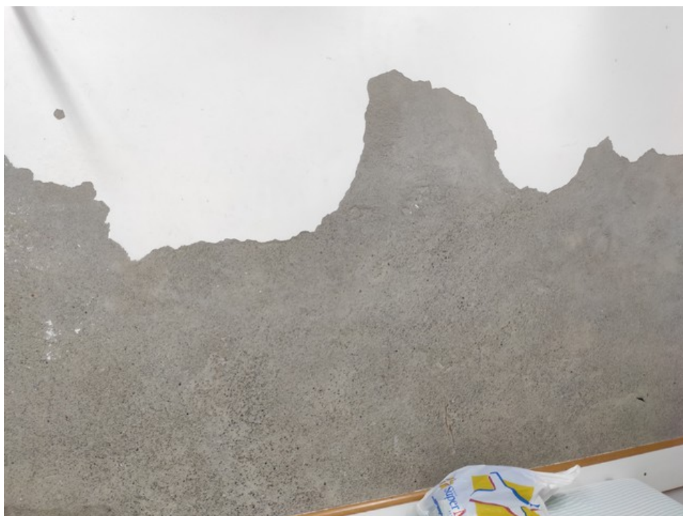
Parede descascada na Sala de curativos
