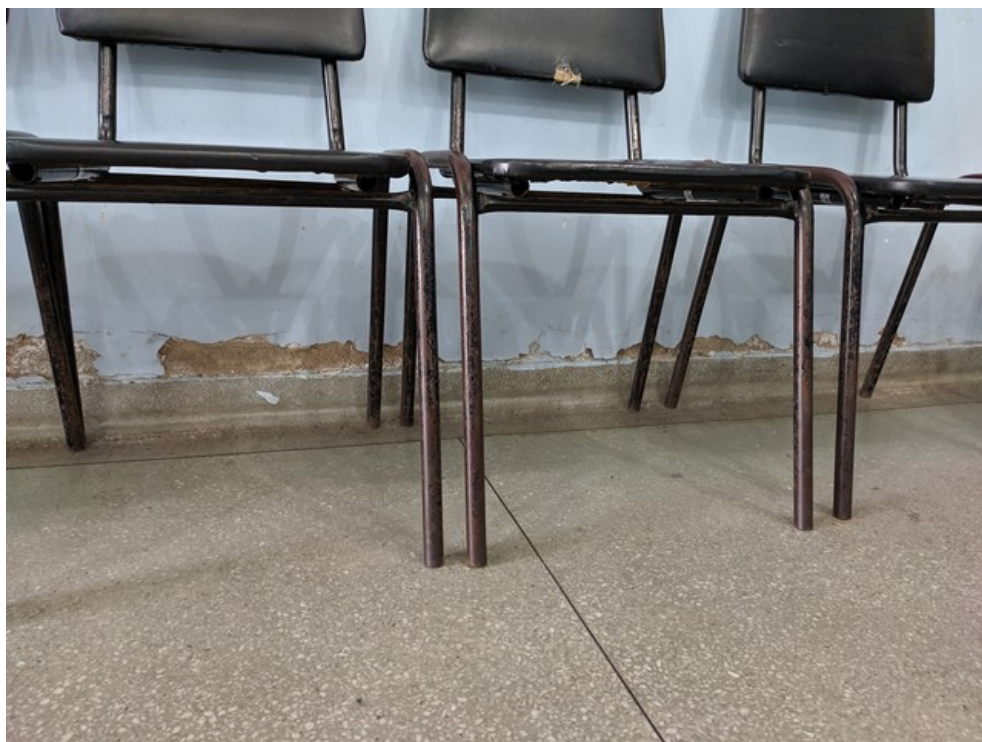
Paredes descascadas na recepção
