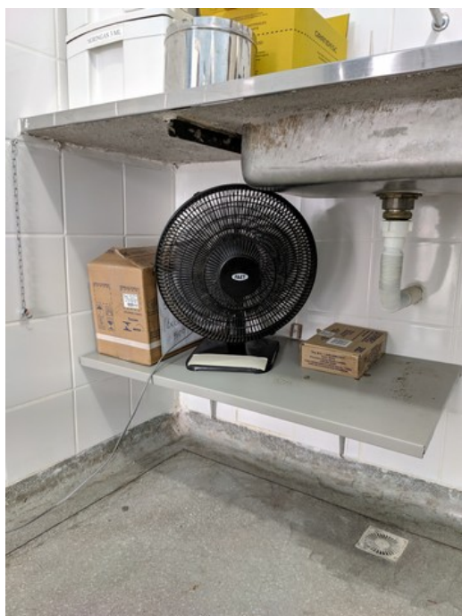
Ventilador em posicionamento improvisado na Sala de Vacinas
