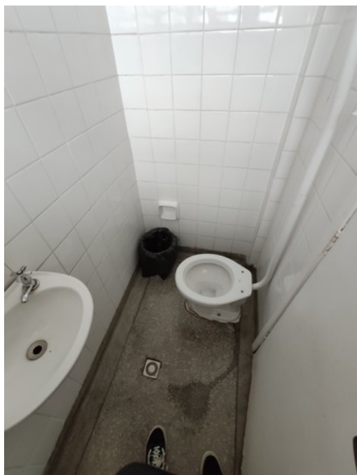
Banheiro de usuários muito pequeno e sem condições de atender pessoa com deficiência
