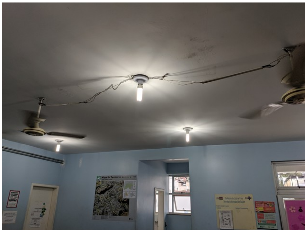
Ventiladores com instalação improvisada na recepção
