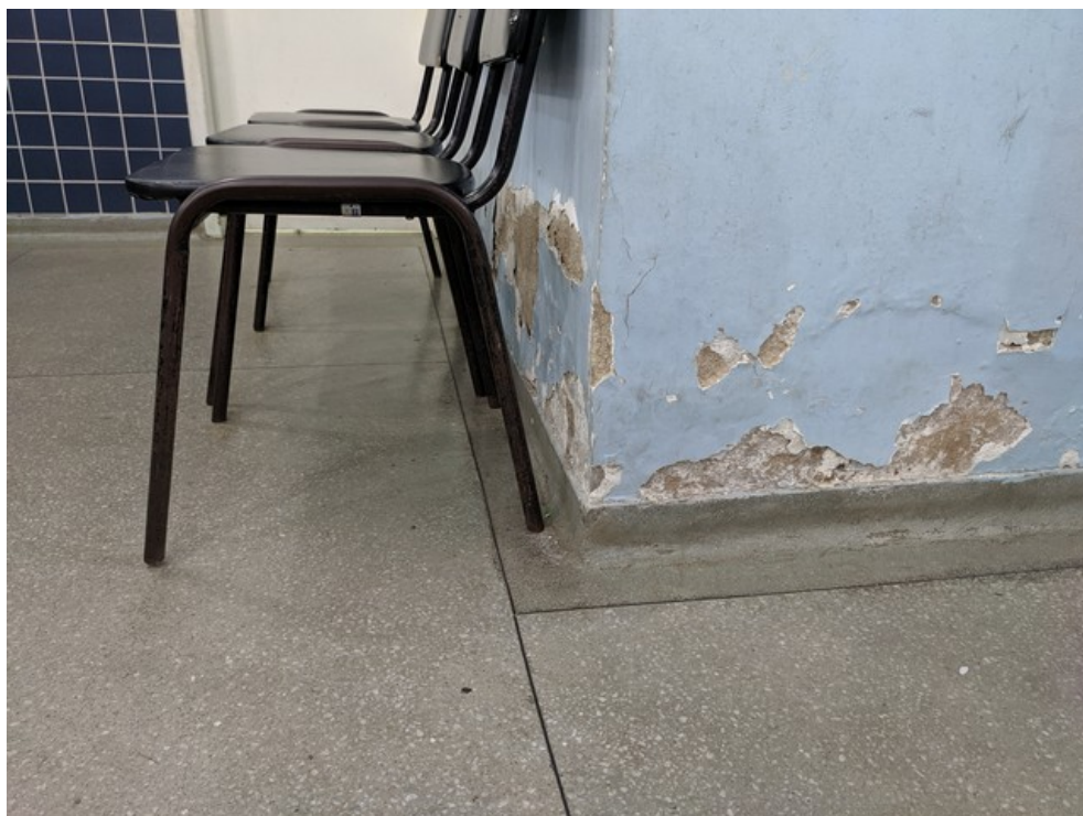
Paredes descascadas na recepção
