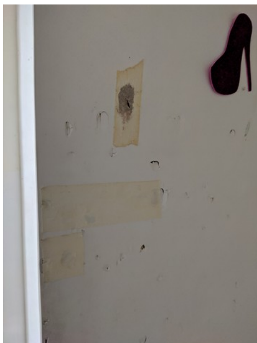
Porta de madeira com cupim
