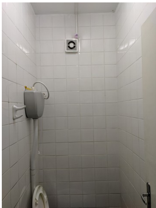
Banheiro masculino de funcionários sem ventilação, com exaustor em mau funcionamento
