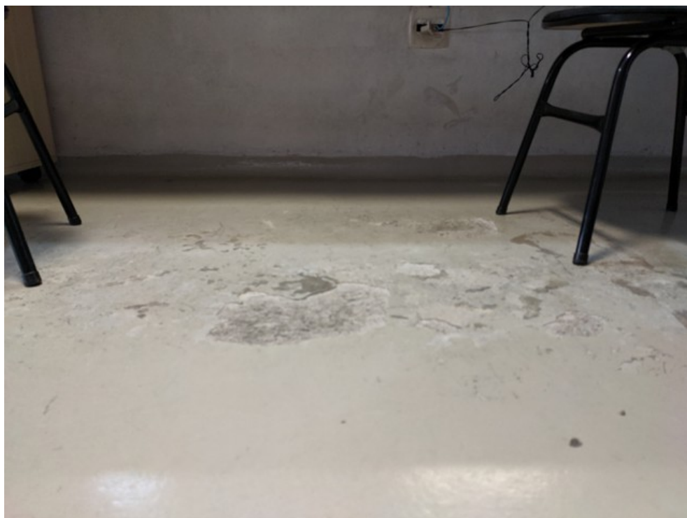
Piso inadequado da Sala de Urgência
