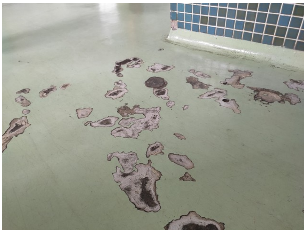
Piso inadequado na Sala de Observação - Adulto e Infantil
