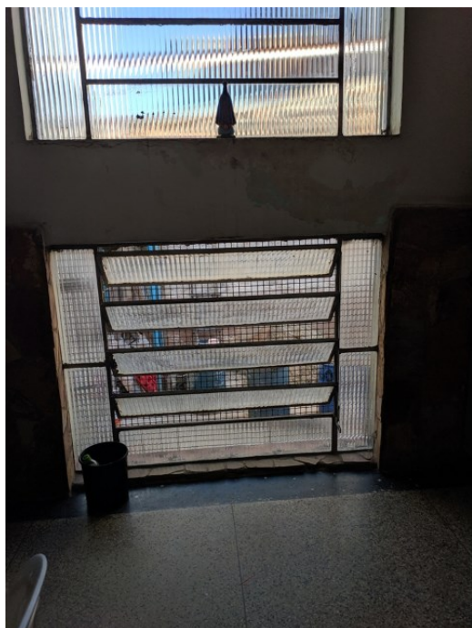
Janela que não pode ser fechada, no corredor que liga o primeiro ao segundo andar
