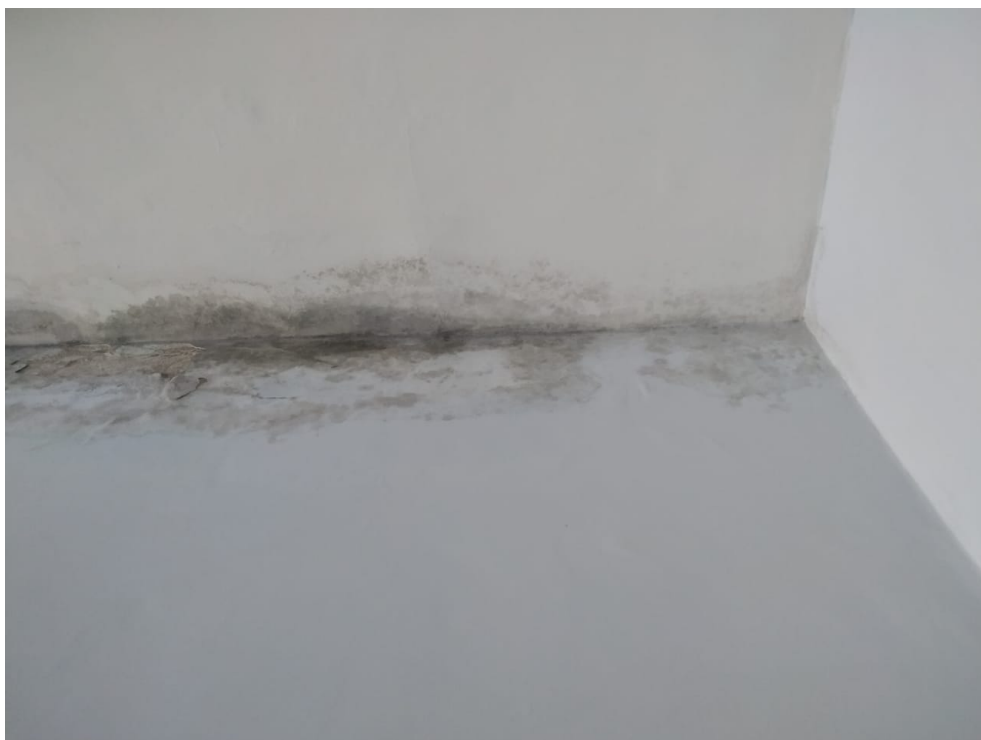
Infiltração no prédio
