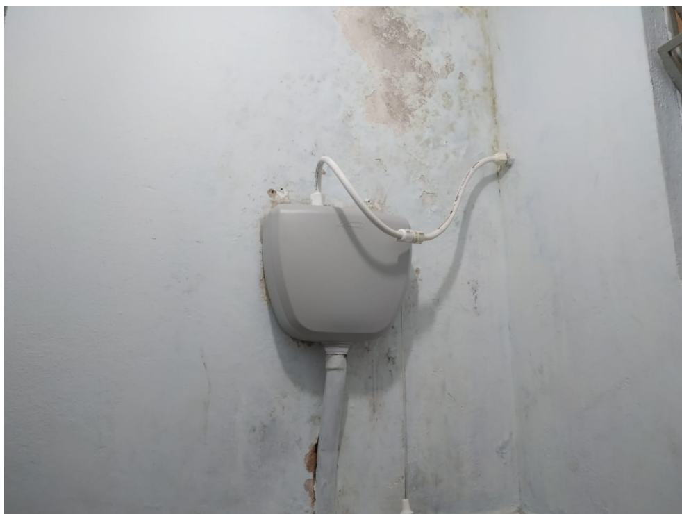
Marca de infiltração no banheiro
