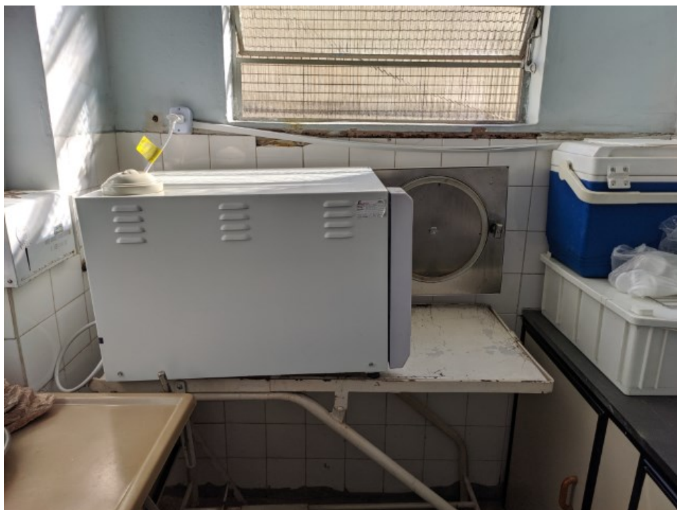
Autoclave armazenado improvisadamente na Sala de Esterilização
