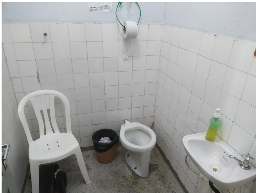
Banheiro dos funcionários necessitando de reparos
