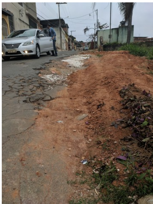
Presença de buraco na via
