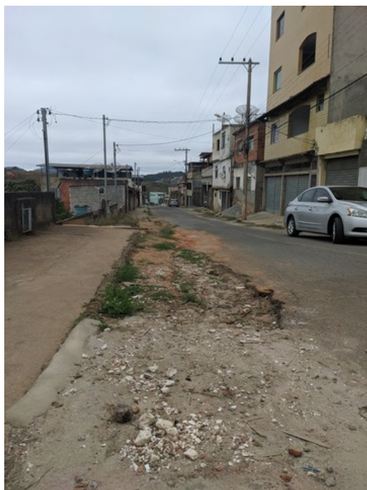
Presença de buraco na via
