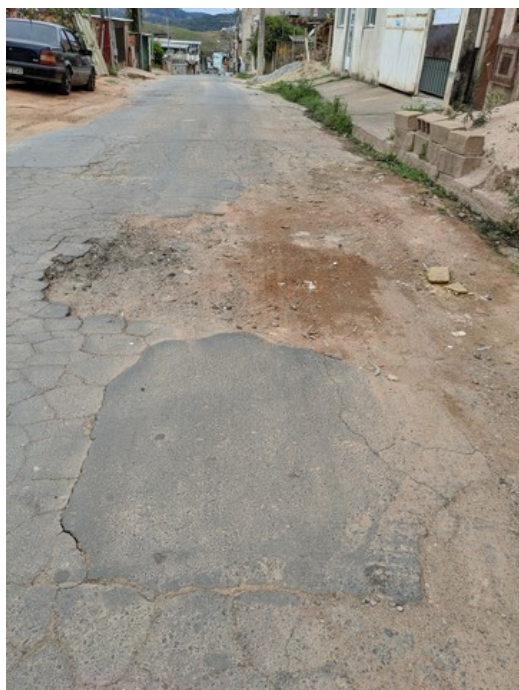
Presença de buraco na via
