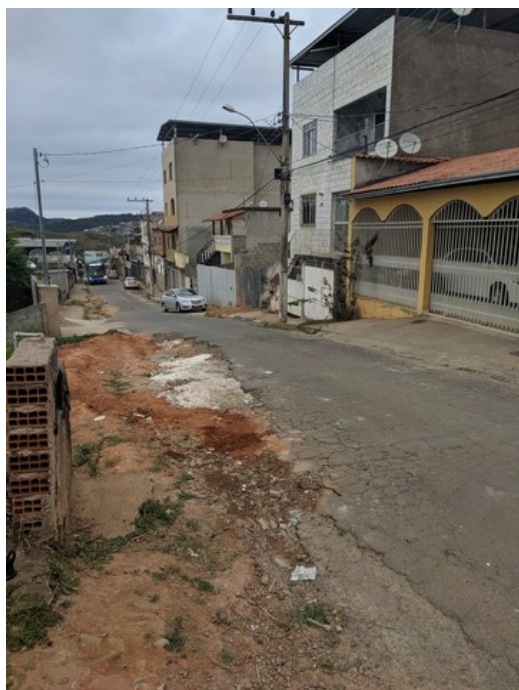
Buraco ocupando metade da faixa de asfalto (próximo ao nº265)
