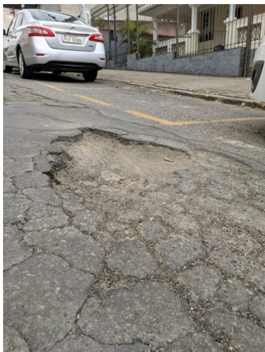
Presença de buraco na via
