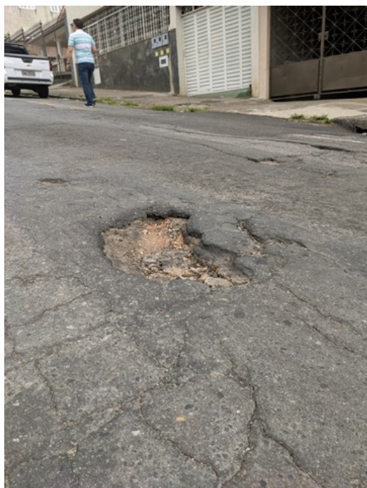
Presença de buraco na via
