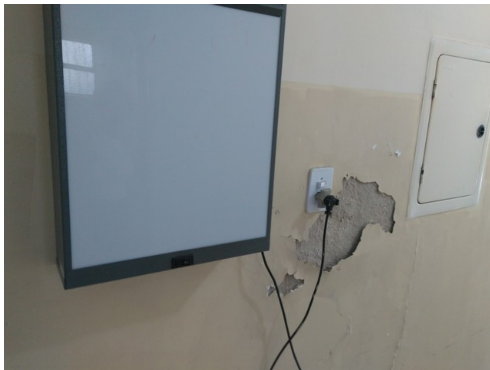
Parede descascada no corredor, em fevereiro
