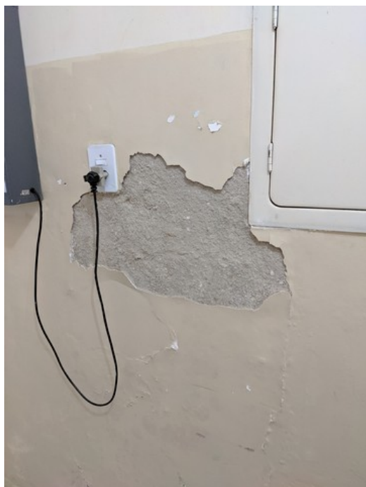
Parede descascada no corredor
