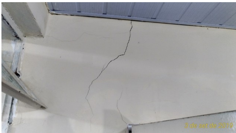
Rachadura na parede da sala de agente comunitário
