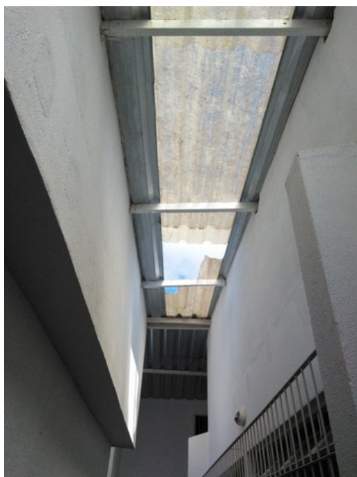
Área lateral com teto improvisado, em fevereiro
