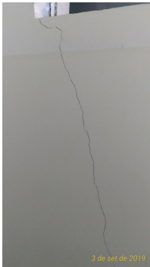
Rachadura na parede do corredor
