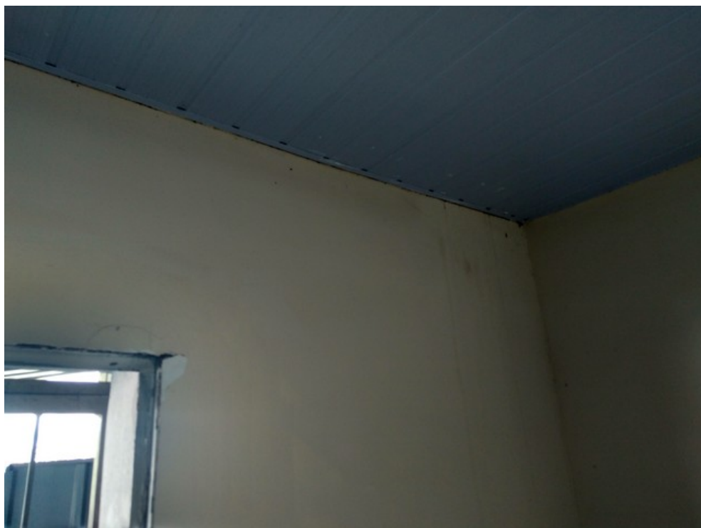
Infiltração na sala dos agentes comunitários, em fevereiro
