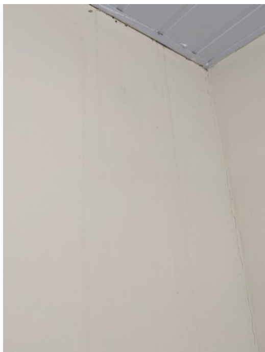
Infiltração na sala de agente comunitário
