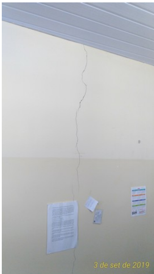
Rachadura na parede da sala de agente comunitário
