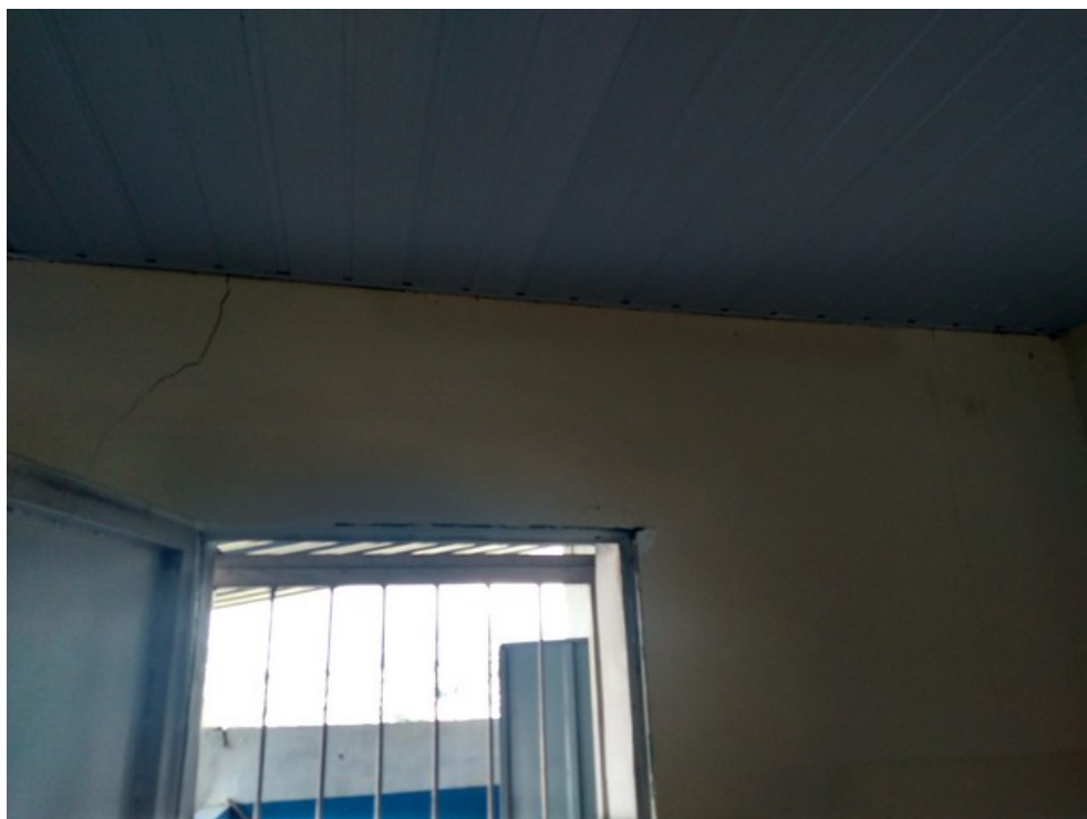
Rachadura na parede e infiltração na sala dos agentes comunitários, em fevereiro
