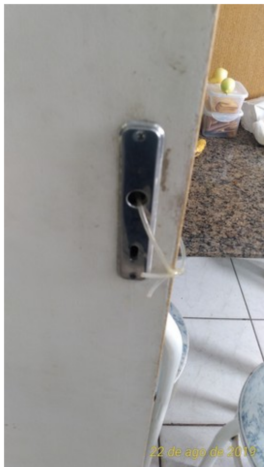
Fechadura da cozinha danificada
