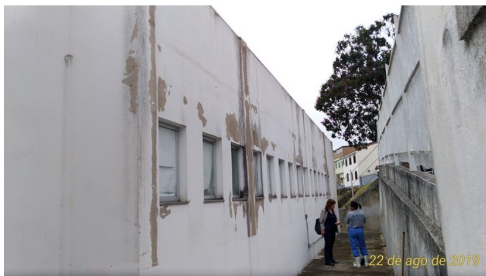
Parede externa com pintura danificada
