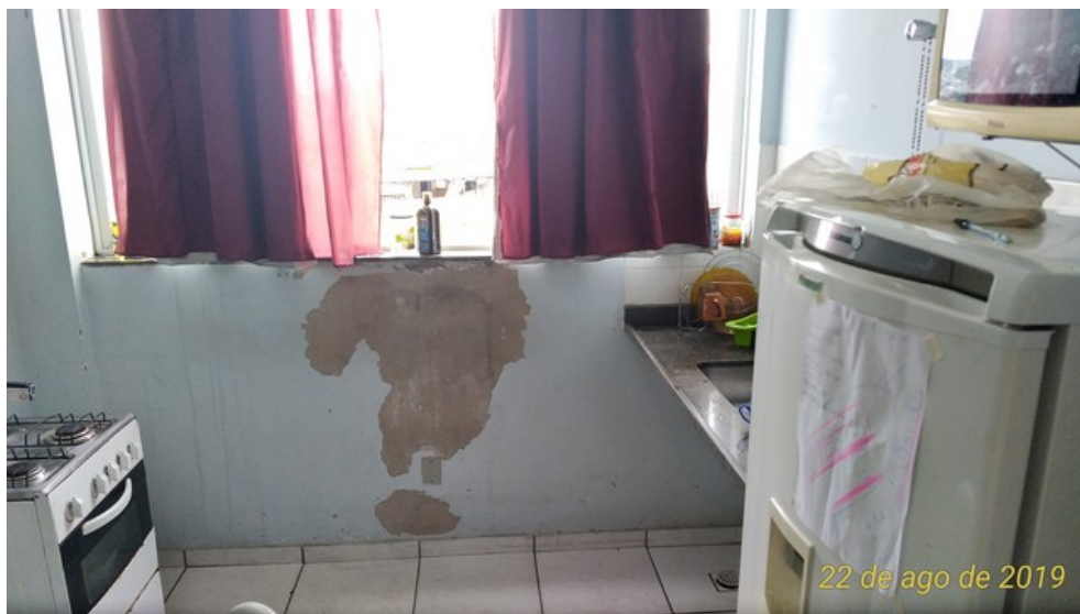
Cozinha com danos na parede (pintura)
