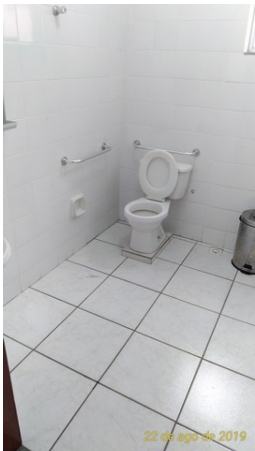
Banheiro masculino em boas condições físicas, porém apresenta mau cheiro (esgoto)
