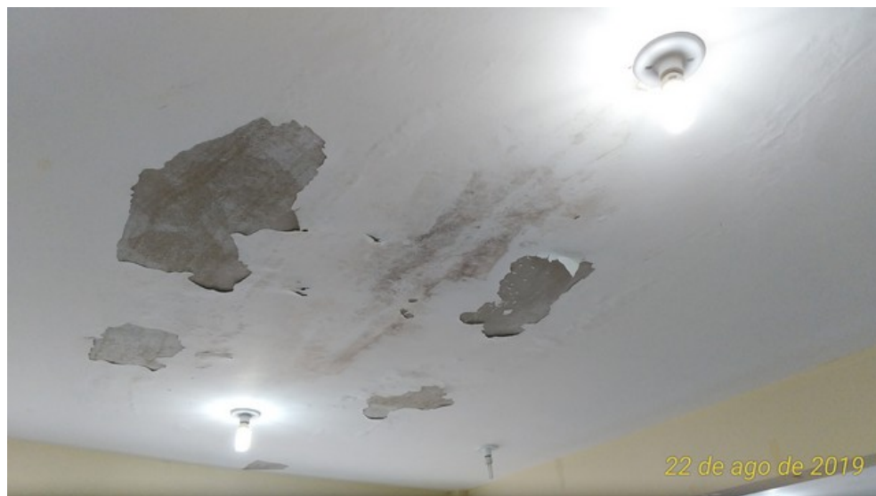
Teto com pintura descascada
