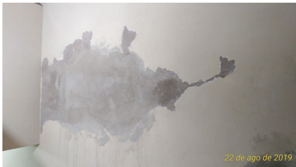
Parede interna com pintura danificada
