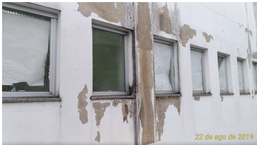
Parede externa com pintura danificada
