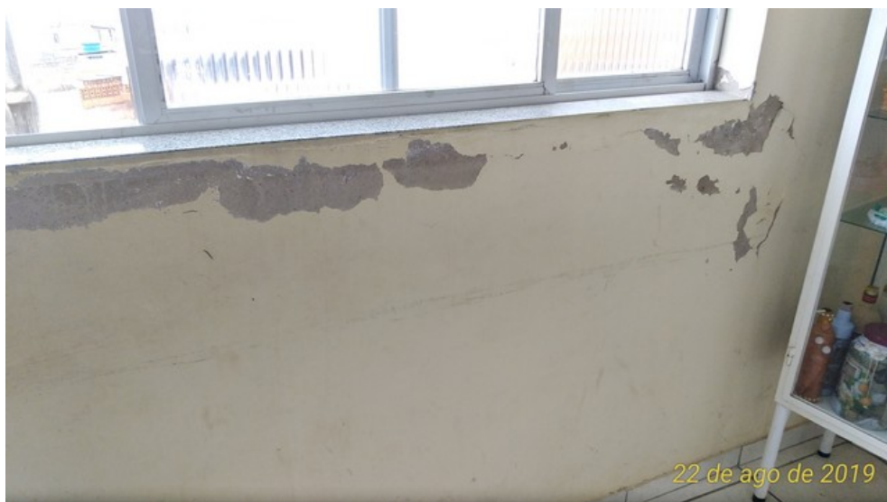
Parede interna com pintura danificada
