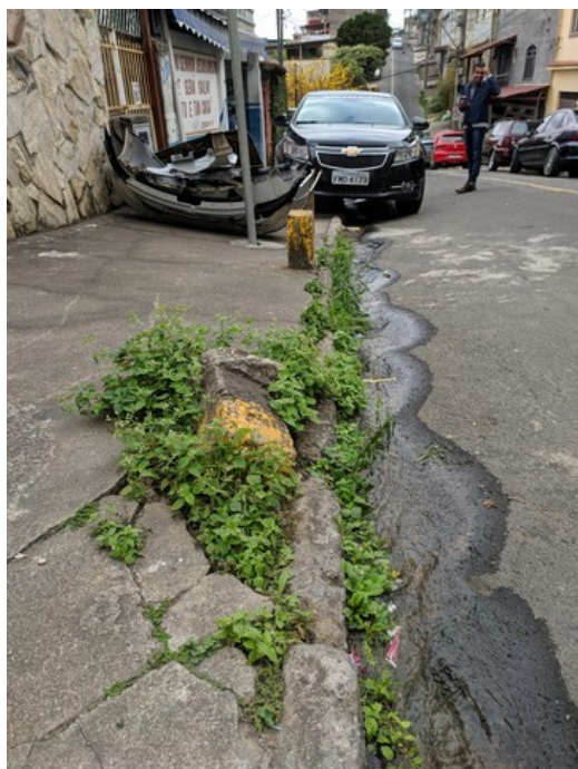
Barreira de contenção de veículo danificada
