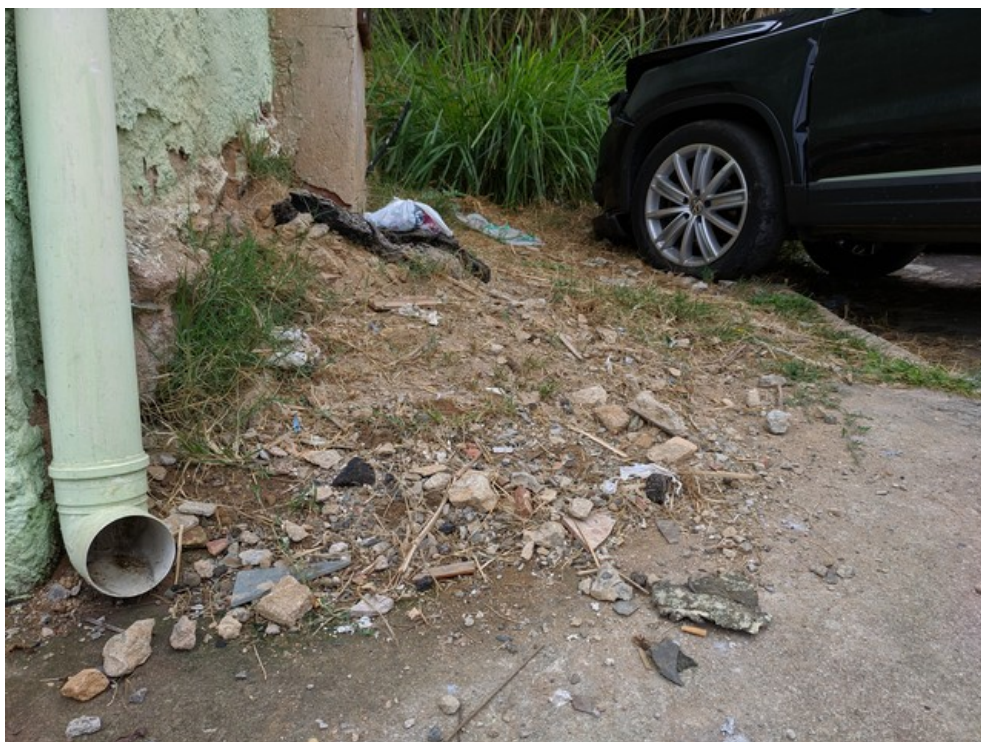
Pedras soltas na calçada
