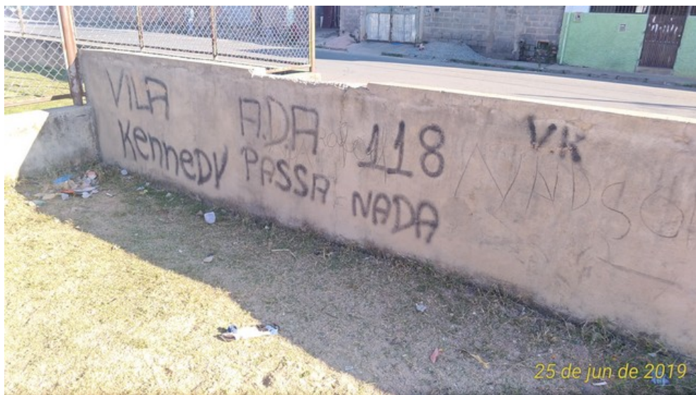
Pichação e ausência de alambrado
