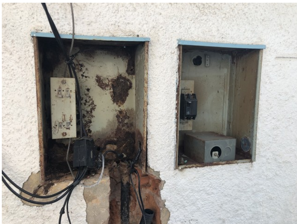
Caixa de Passagem de energia
