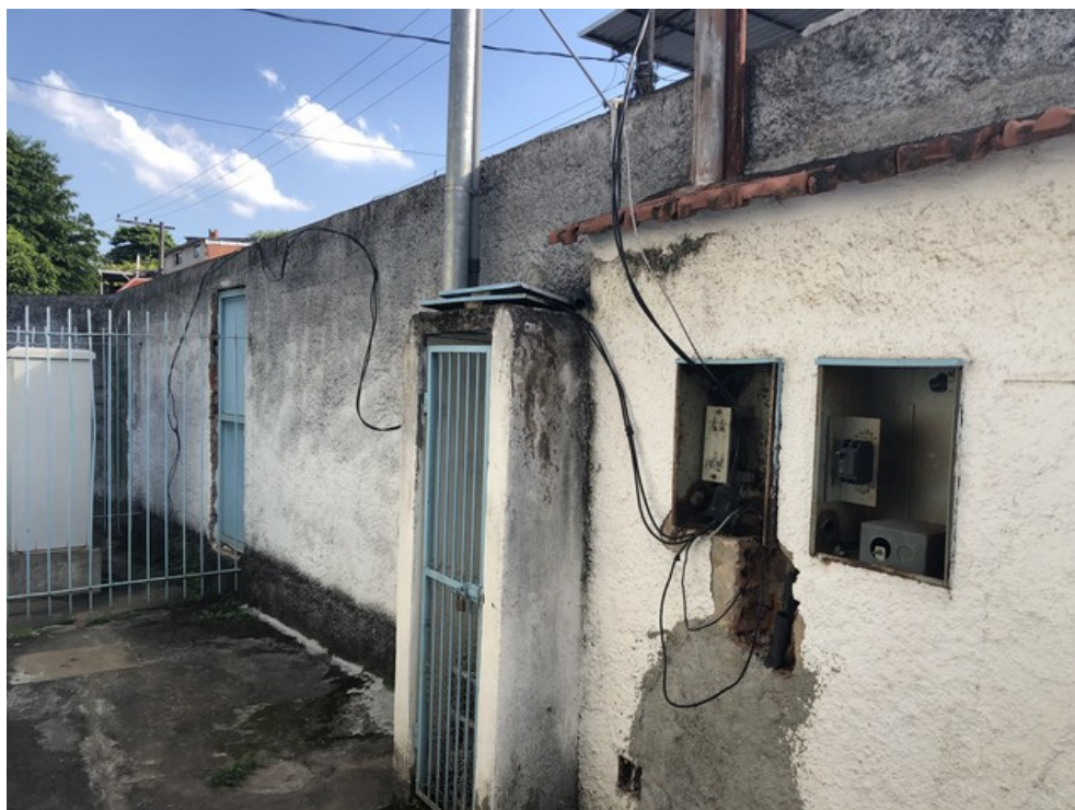
Caixa de Passagem de energia
