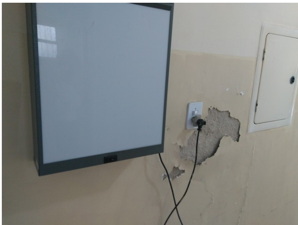
Infiltrações nas paredes do corredor interno da unidade
