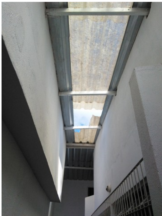
Teto danificado na área externa
