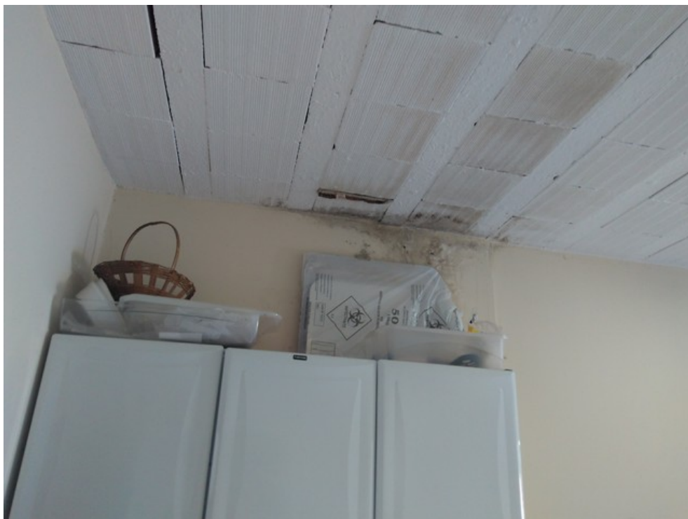
Copa e cozinha - Infiltrações
