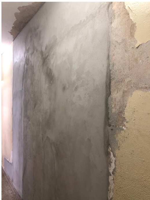
Infiltrações nas paredes do corredor interno da unidade
