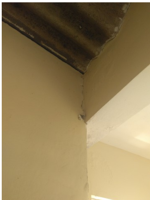
Infiltrações no telhado entre os pavimentos da unidade
