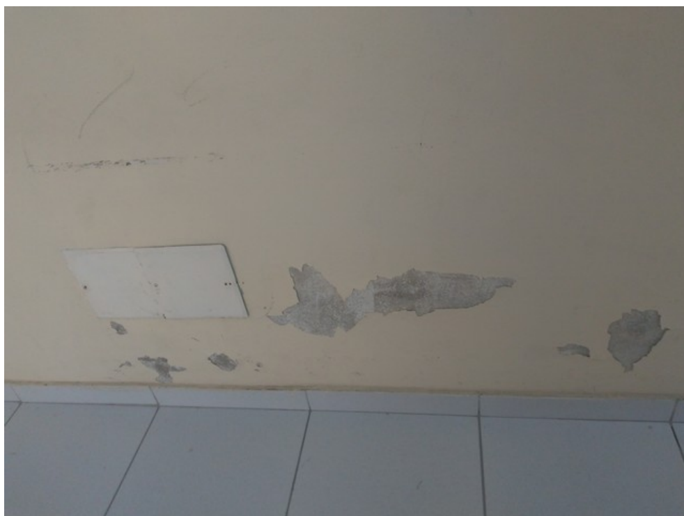
Pintura danificada no corredor de acesso ao segundo pavimento da unidade
