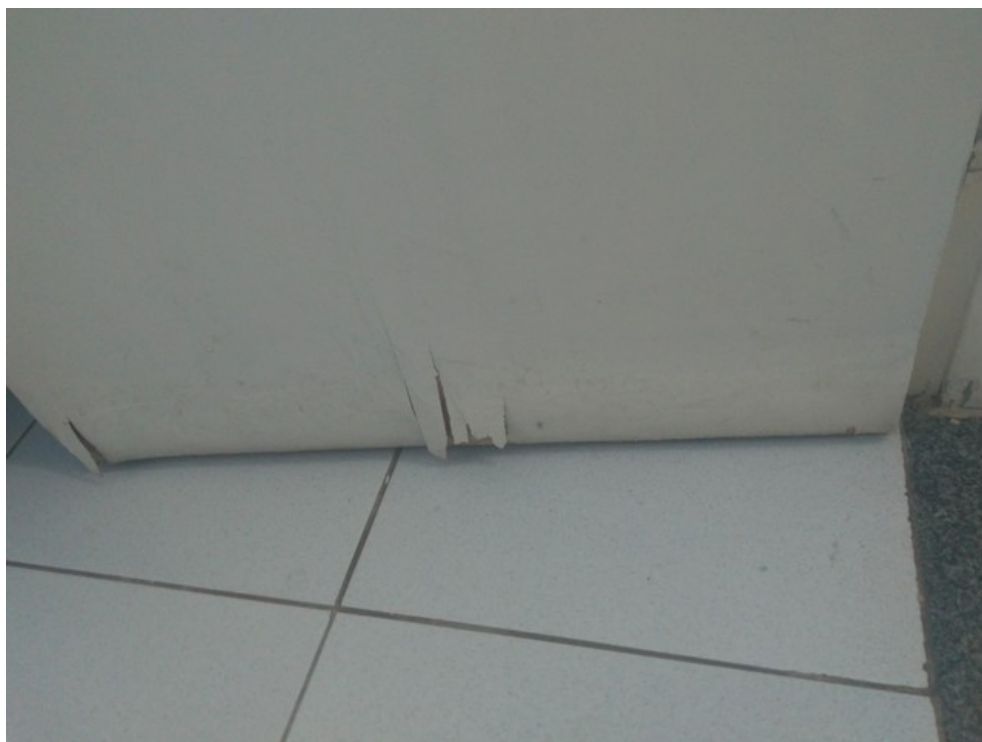
Porta da farmácia danificada por infiltração do teto
