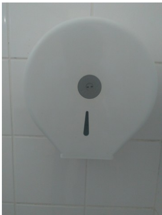
Dispensadores de Papel. Vazios em todos os banheiros
