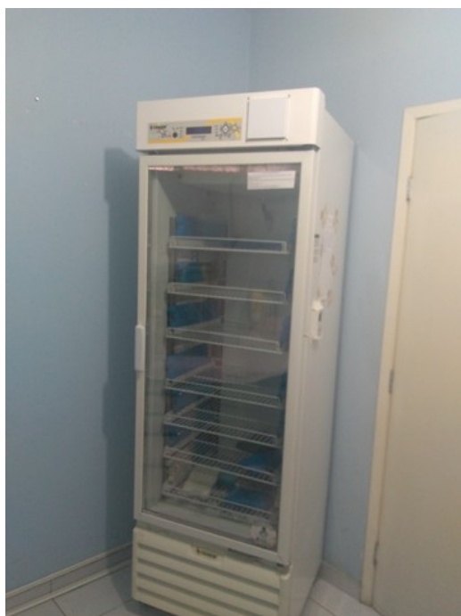
Câmara Fria para vacinas. Encontra-se danificada sem possibilidade de uso.
