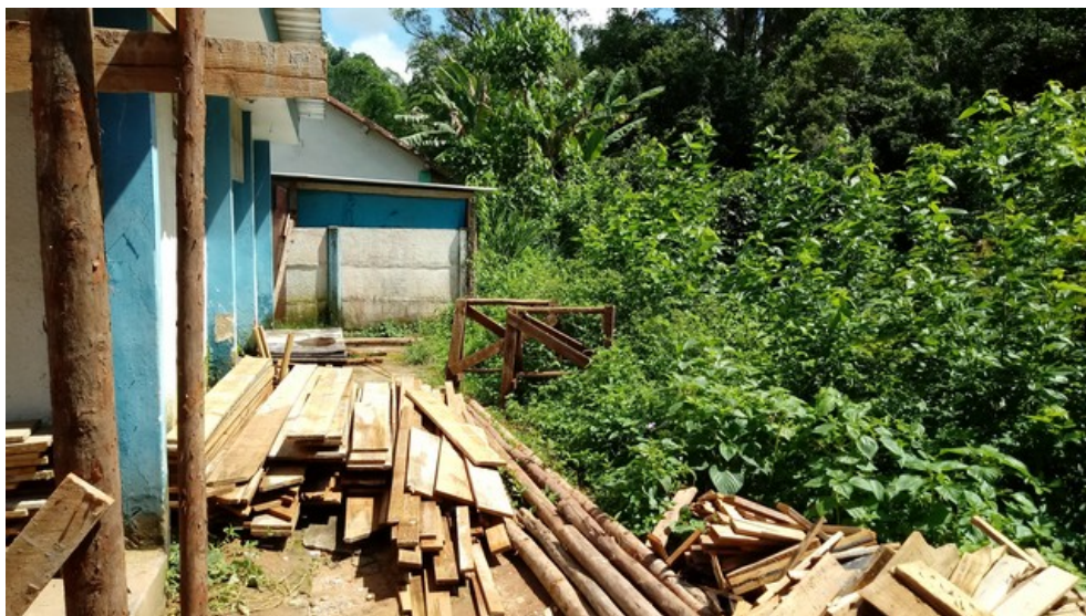
Área atrás da unidade onde o muro desabou.
