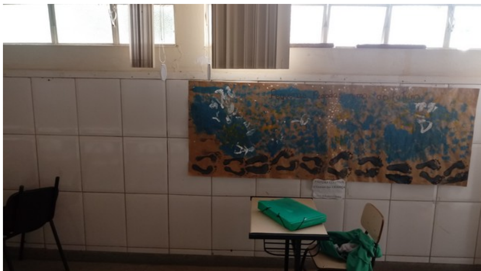
Parede da sala 02 onde o revestimento está desprendendo-se
