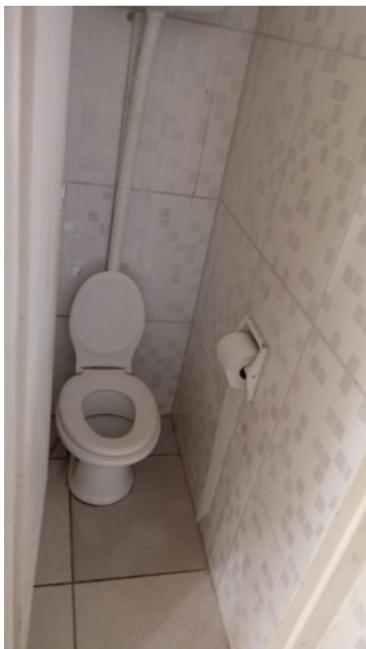
Banheiro adaptado para alunos na sala02 - parte masculina não funcional
