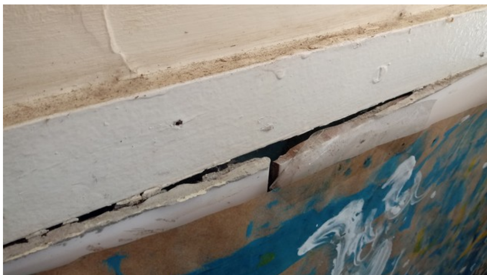
Revestimento da parede da sala 02 desprendendo-se da parede
