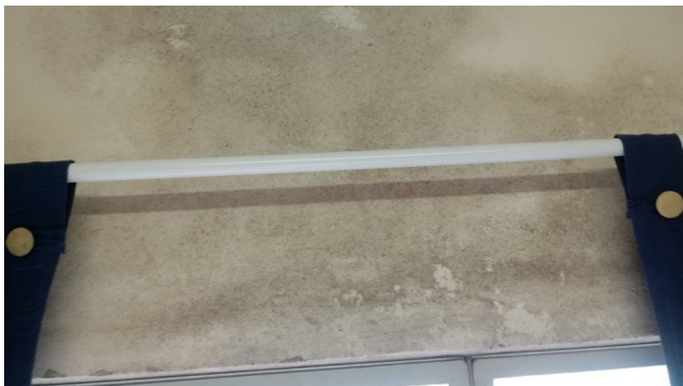
Infiltrações no Consultório Ginecológico e Clínico
