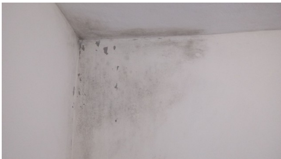
Infiltrações no Consultório Clínico 02
