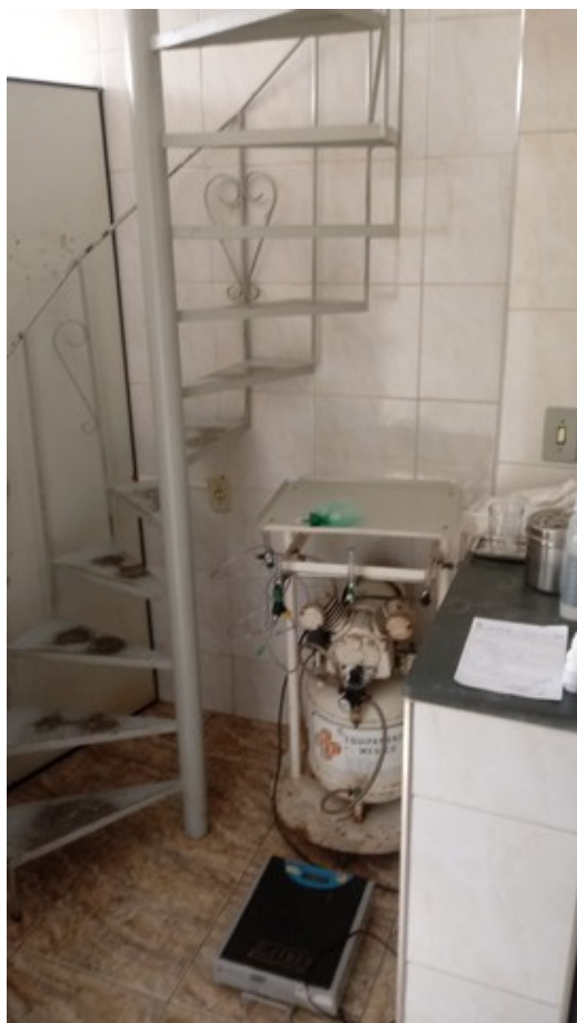
Compressor de nebulização sob a escada de acesso da cobertura
