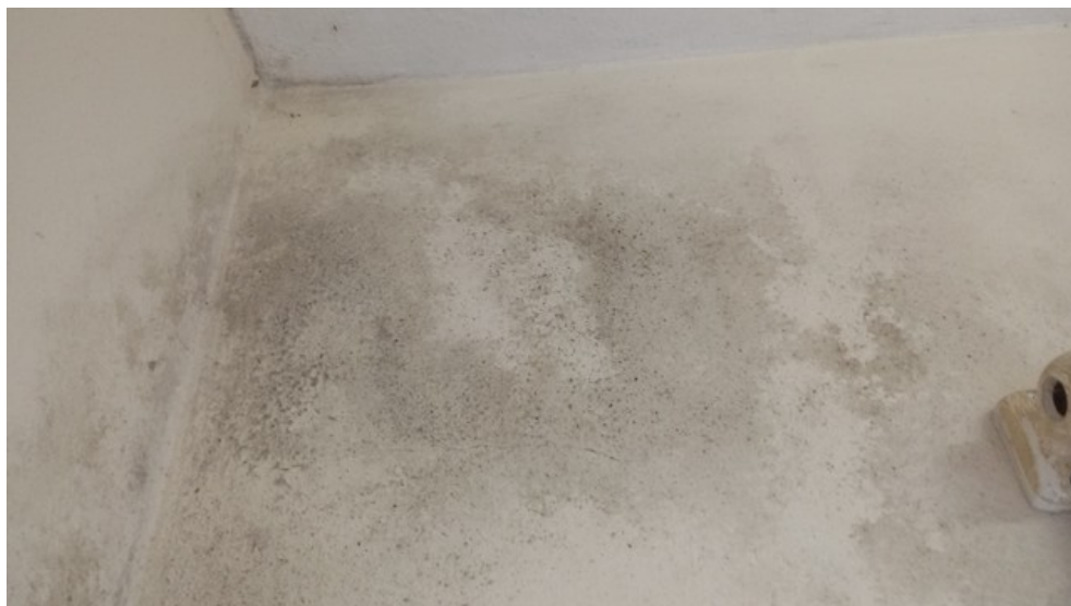
Infiltrações no Consultório Ginecológico e Clínico
