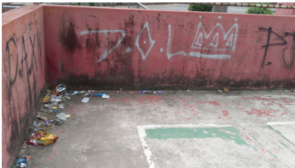
Quadra de esportes - condições de limpeza
