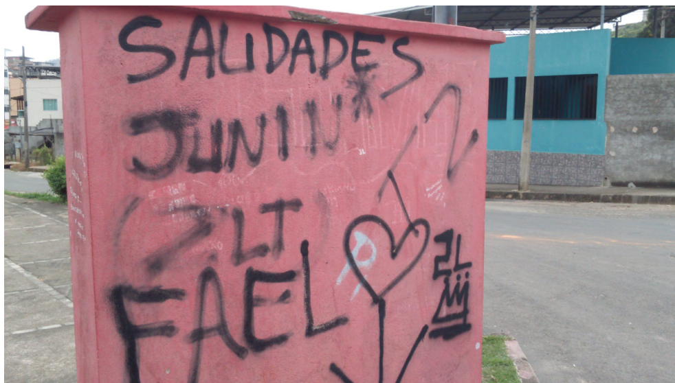
Quadro geral de energia elétrica
