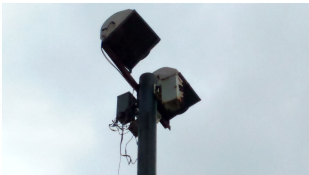
Iluminação da quadra
