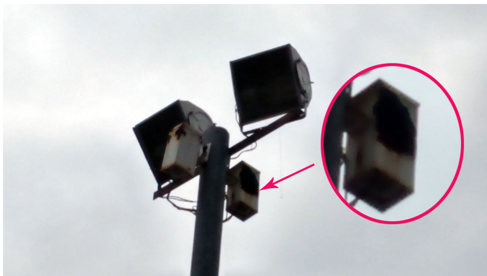
Iluminação da quadra
