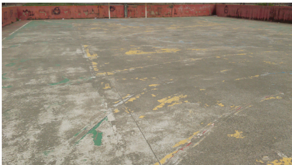
Piso da quadra desgastado (áspero)
