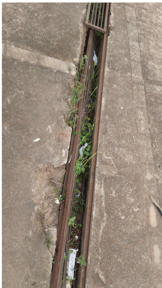
Sistema de escoamento de água pluvial
