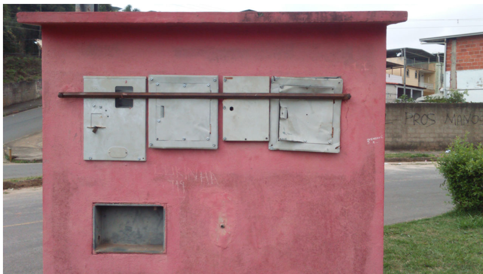
Quadro geral de energia elétrica
