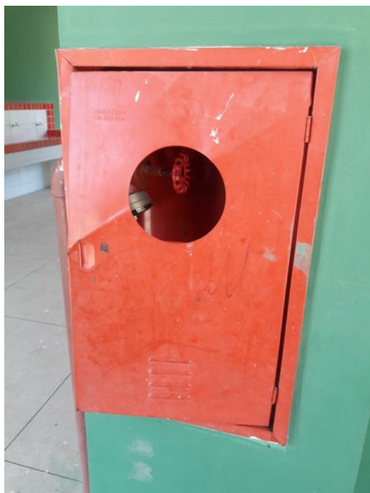
Caixa de hidrante e abrigo de mangueira
